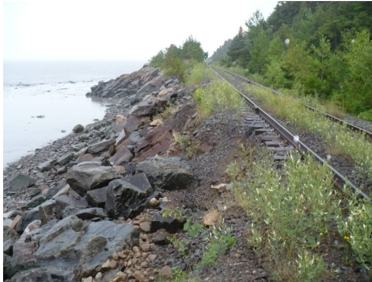
Section de l'énrochement requérant une réfection
