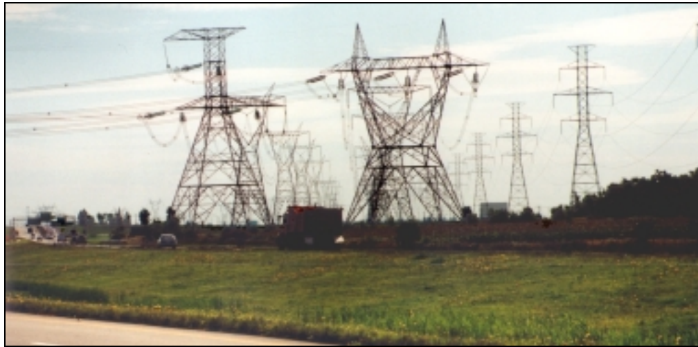
Photo 5-7 — Lignes de transport d'Hydro-Québec, A-30, Boucherville
