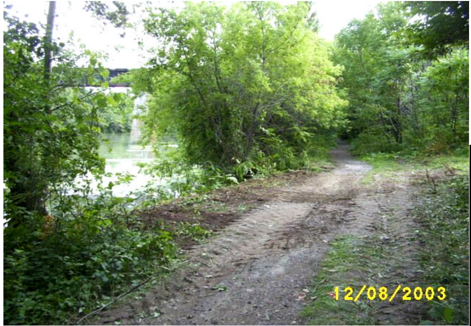
Photo n° 33. État du site de prélèvement suite aux travaux
