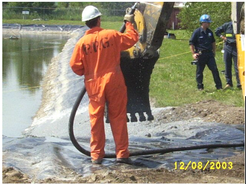
Photo n° 22. Nettoyage des équipements
