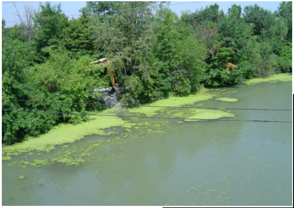
Photo n° 1. Secteur des travaux sur le tronçon amont de la rivière St-Louis – Photo prise à partir du pont ferroviaire
