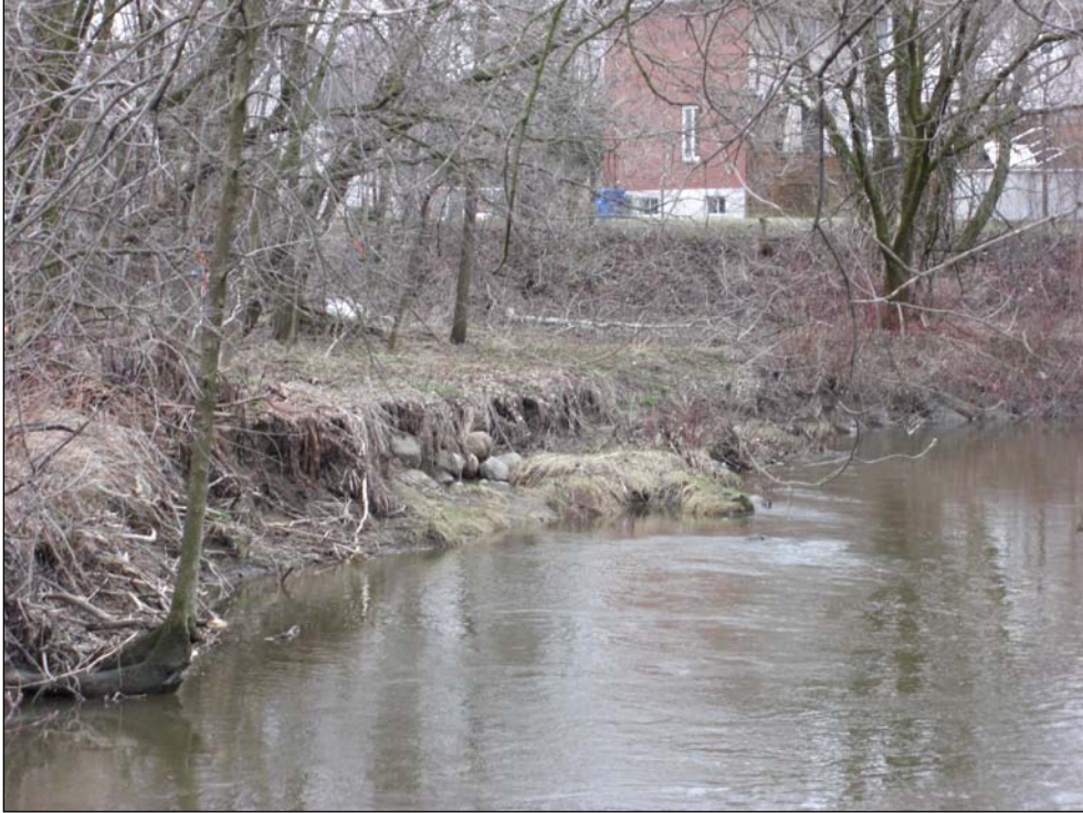
Photo 3 – Déstabilisation de l'empierrement situé près du km 0,85.
