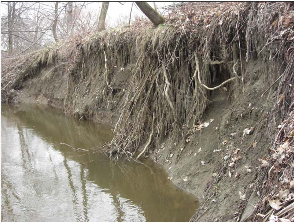
Photo 4 – Zone d'érosion situé près du km 0,4.
