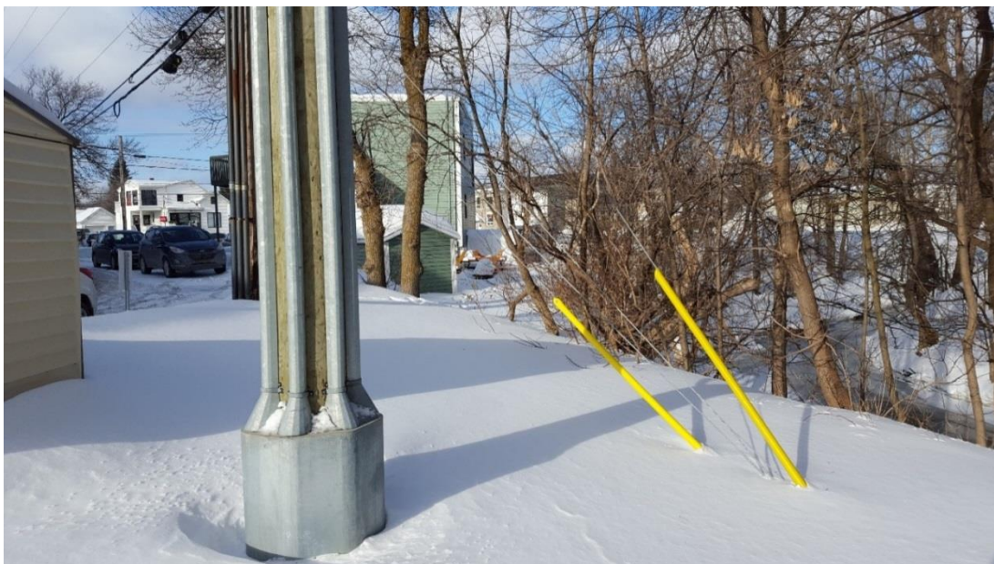
Figure QC-128-6 Secteur du PK 0+700, rive gauche. Vue vers l'aval de la rive où un mur de palplanches est projeté.
