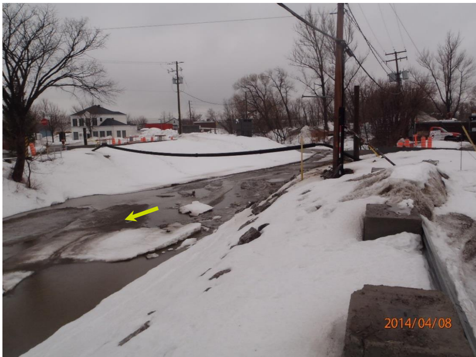
Photo 3 Glace fondue et morcelée au pont des Méandres avant sa reconstruction (8 avril 2014).
