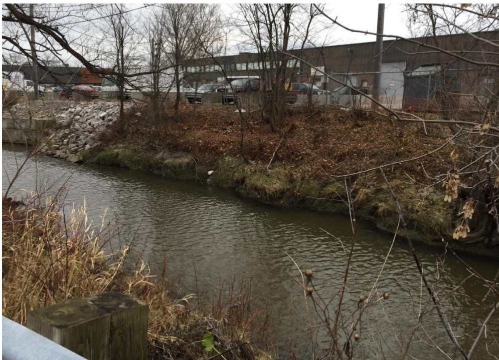
Photo QC-79 État des berges dans le secteur des lots 1 309 618 et 1309 619. Vue de la rive droite vers l'amont.
