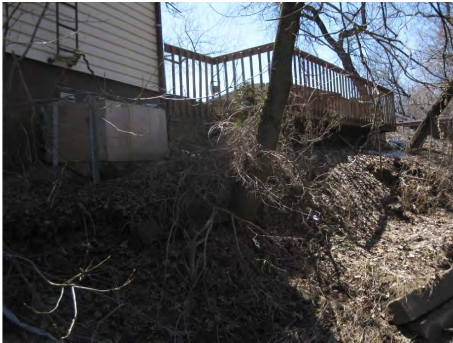
Figure 3.10 Érosion de la rive qui pourrait éventuellement causer des problèmes à certains bâtiments (avril 2016, PK 3,44, rive droite)
