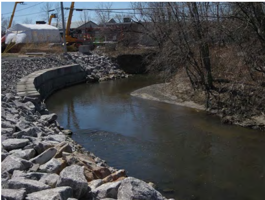
Figure 2.5 Interventions d'urgence en amont du pont des Méandres (avril 2016, PK 2,82, vue vers l'amont)
