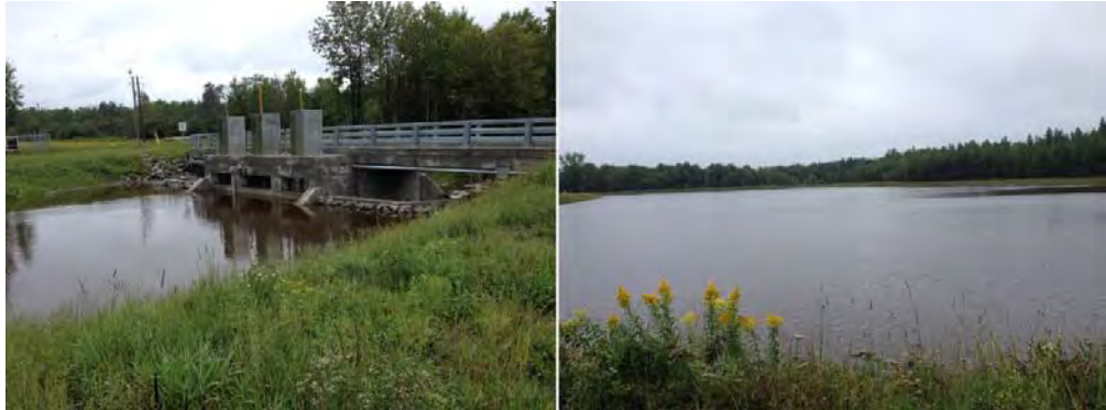
Figure 2.1 Barrages de régulation du ruisseau des Friches (à gauche) et réservoir (à droite) (août 2014)
