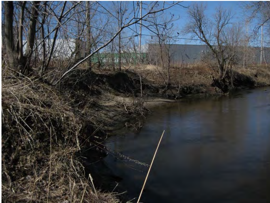
Figure 3.7 Érosion forte sur le tronçon à l'étude (avril 2016, PK 1,93, rive droite)
