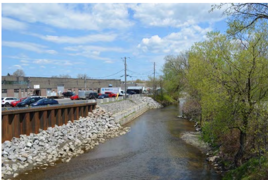
Figure 2.4 Interventions d'urgence en aval du pont des Méandres (mai 2016, PK 2,77, vue vers l'aval)
