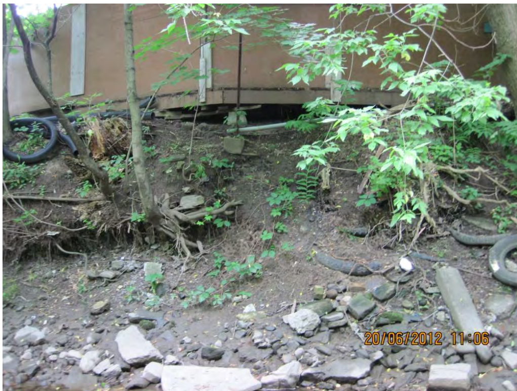
Figure 3.10 Érosion de la berge qui pourrait éventuellement causer des problèmes à certains bâtiments
