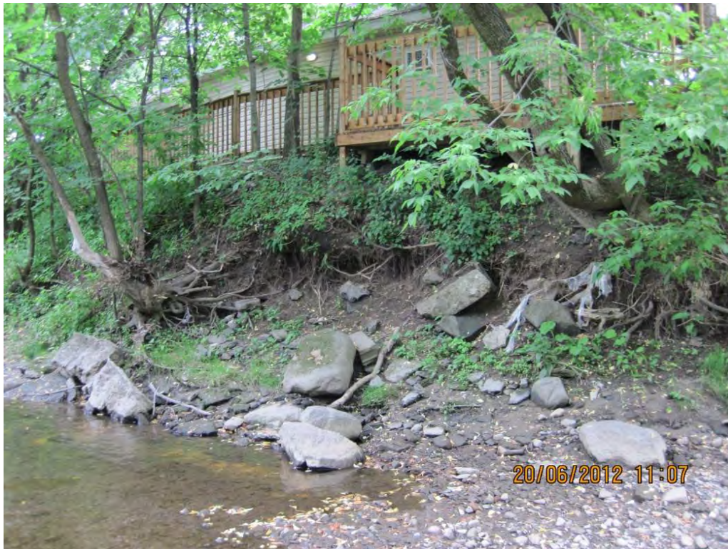
Figure 3.9 Érosion de la berge qui pourrait éventuellement causer des problèmes à certains bâtiments
