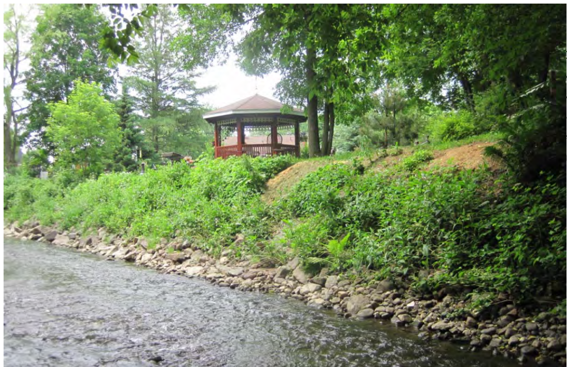
Figure 3.13 Conditions actuelles des rives en bordure d'un terrain résidentiel en rive droite (PK 3,74)
