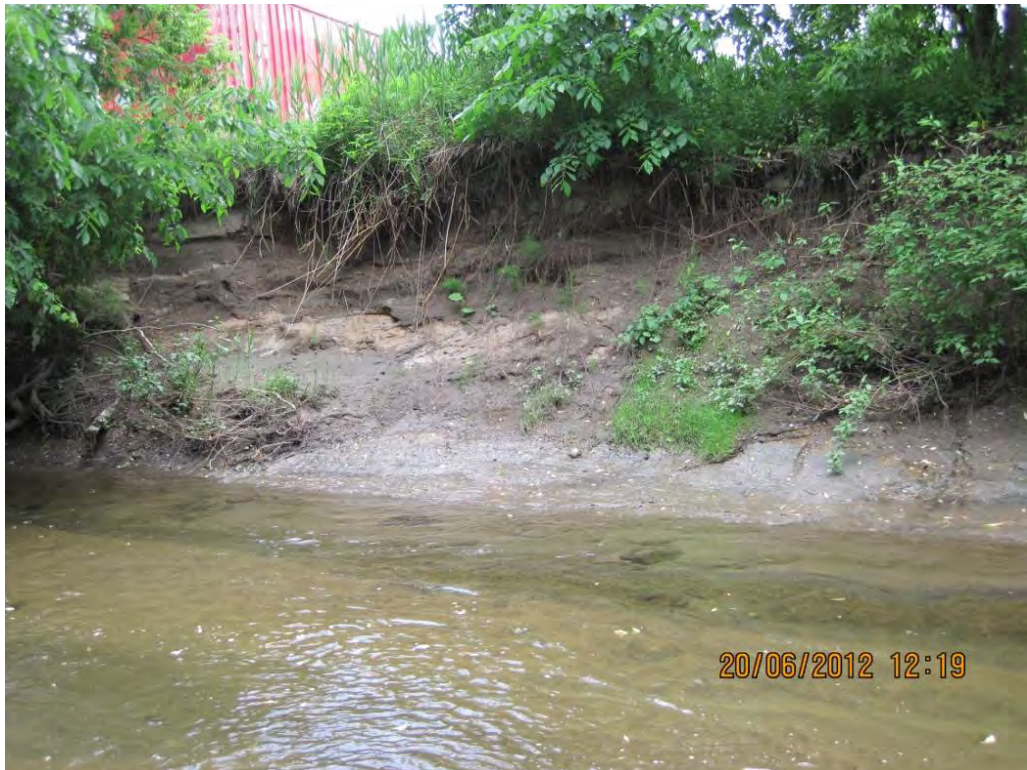
Figure 3.7 Érosion forte sur le tronçon de la rivière Lorette à l'étude
