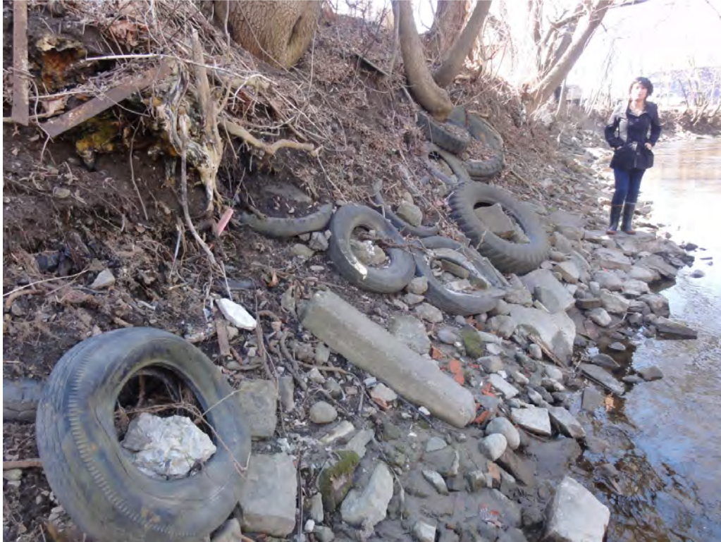
Exemple de rebus à gérer lors des travaux de remodelage des rives (PK 3,57, rive droite).
