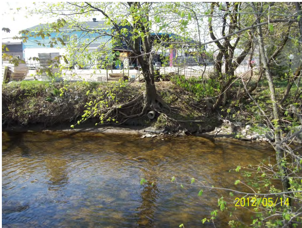
Infrastructures existantes en rive droite de la rivière et conduite de drainage d'arrière lot (PK 3,24, rive droite).
