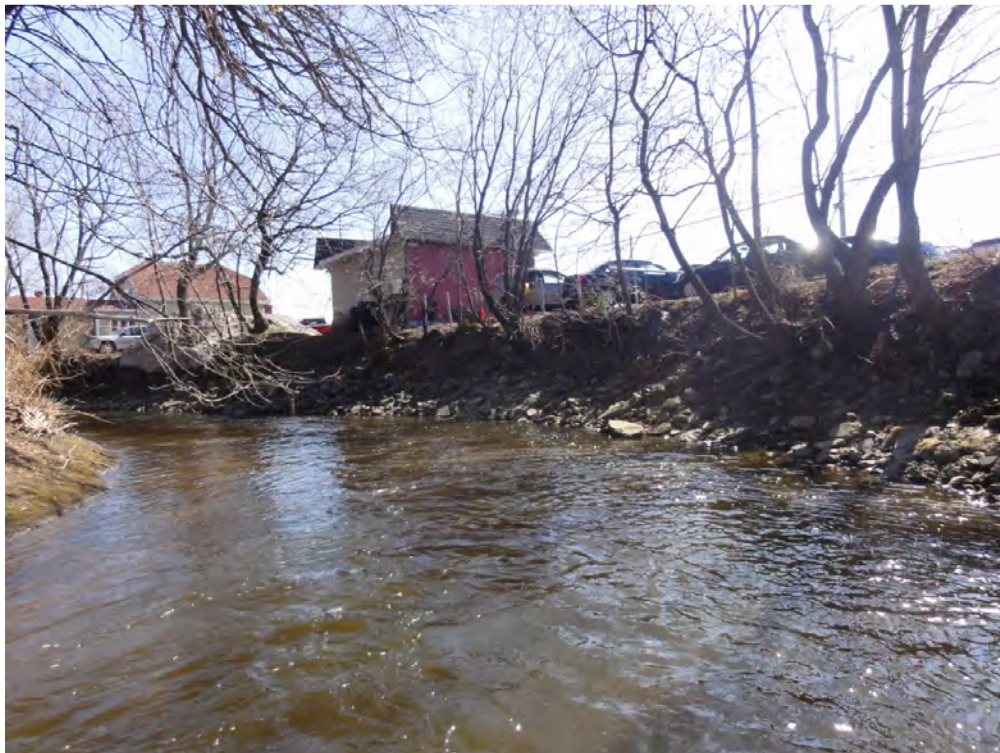
Érosion importante des rives en rive droite de la courbe à proximité du boulevard Wilfid-Hamel (PK 3,60, vue vers l'aval).
