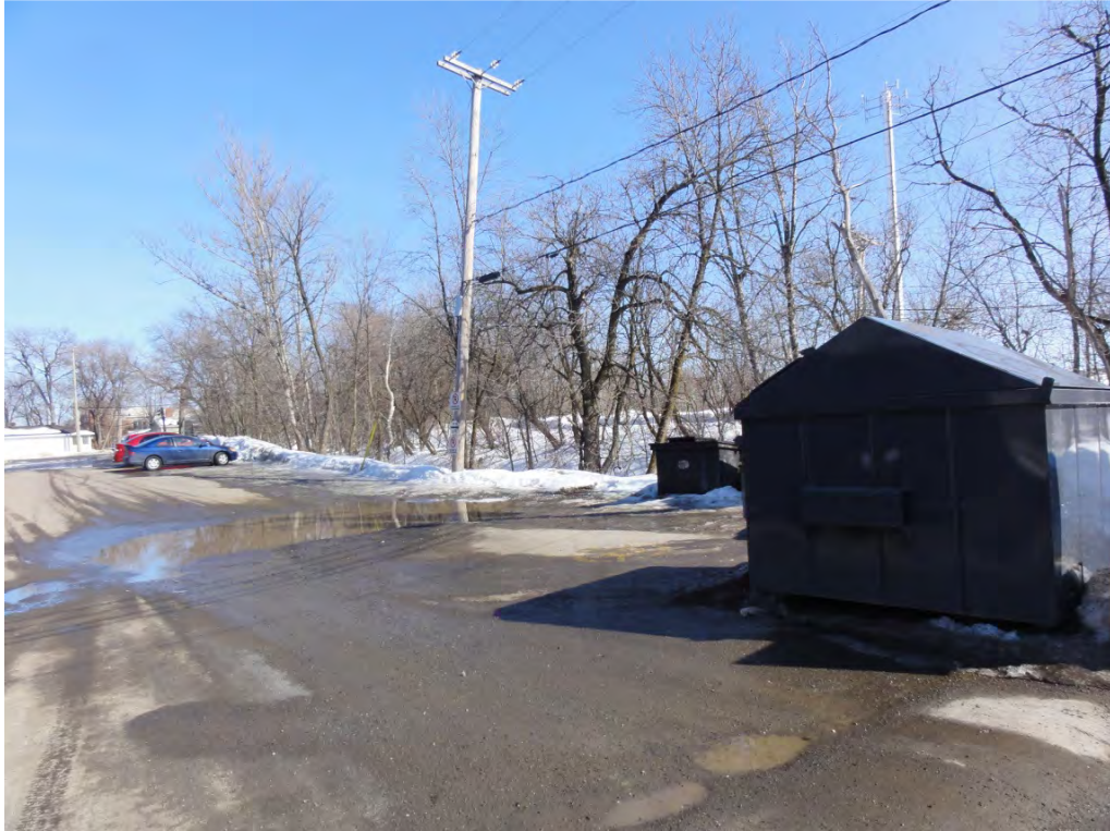
Point bas, zone de débordement en rive gauche (PK 2,62).
