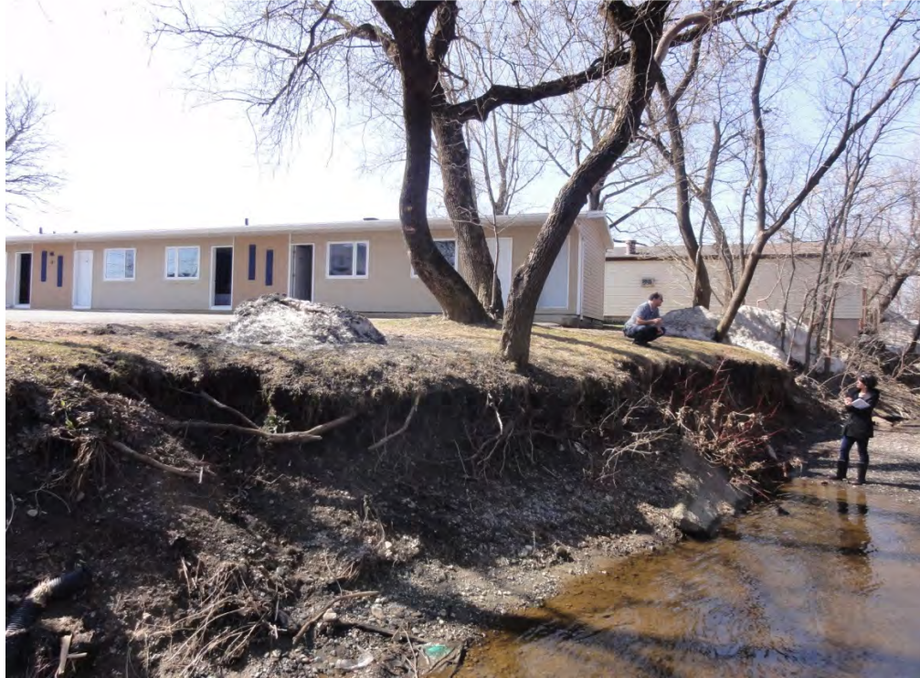
Importante érosion des rives (PK 3,43, rive droite).
