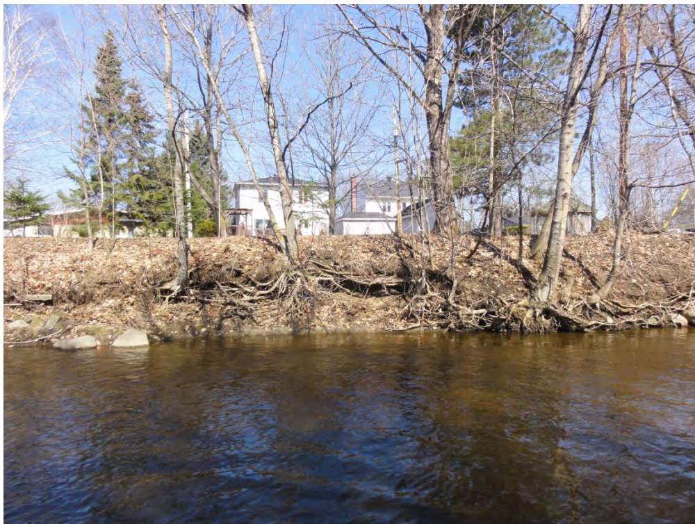
Érosion des rives et présence d'arbres instables (PK 3,48, rive gauche).
