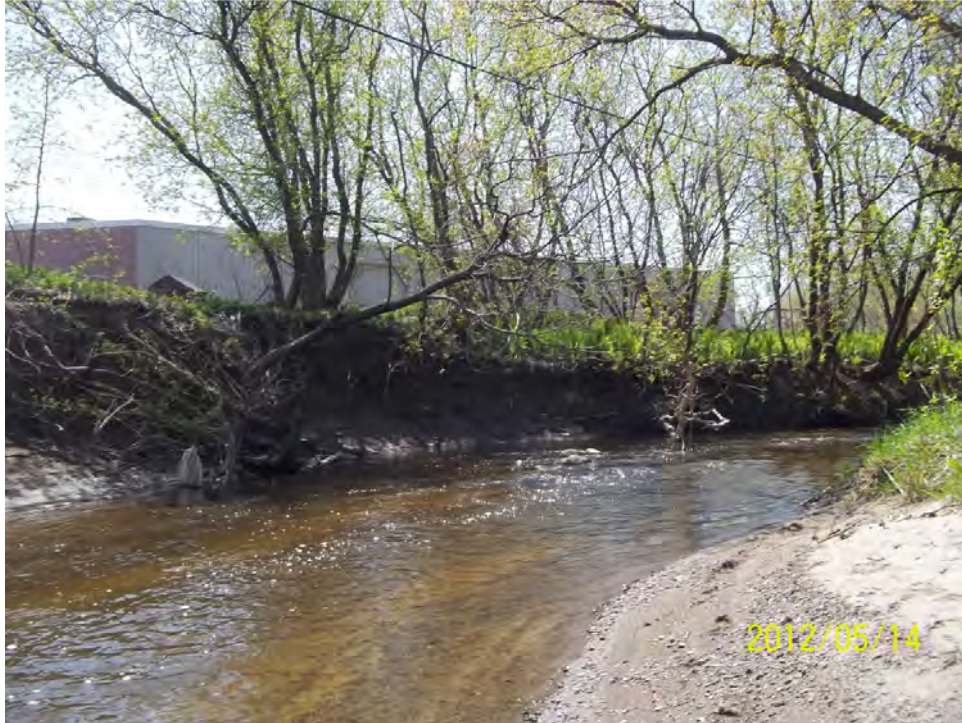
Importante érosion des rives dans la partie extérieure de la courbe (PK 2,88, rive droite, vue vers l'amont).
