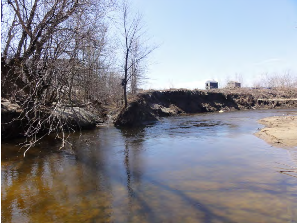
Arrivée du fossé de drainage et risque d'affaissement de la rive (PK 2,08, rive droite).
