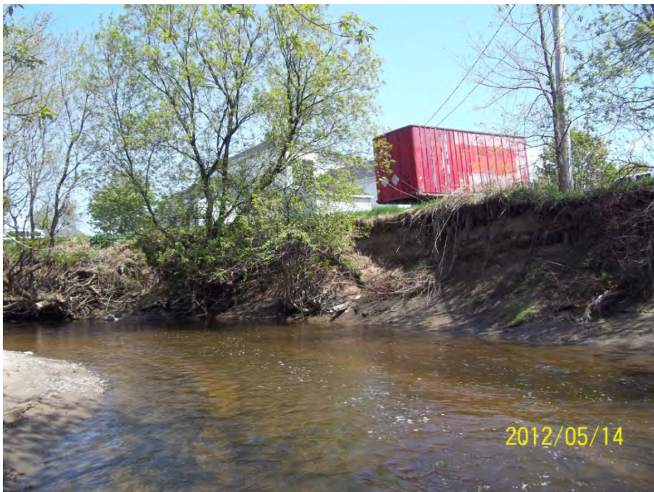
Photo 13 Secteur Wilfrid-Hamel aval, zone d'érosion au PK 2,86 rive droite et arrière-cour commerciale près du haut de talus de la rive.
