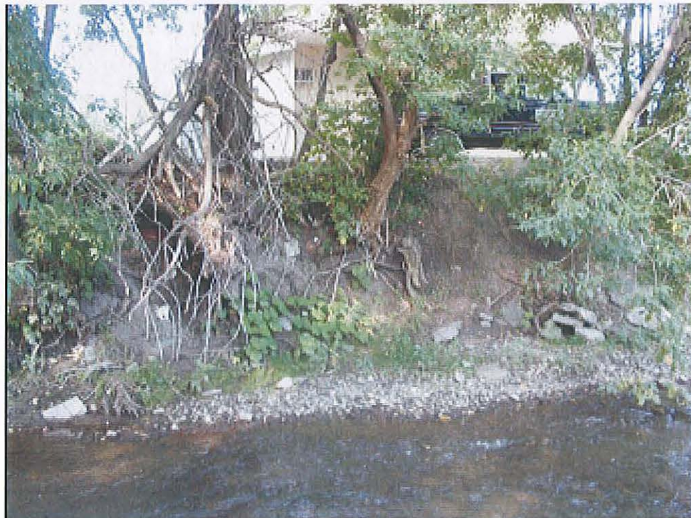
Photo 4.4 : Érosion importante de la rive
