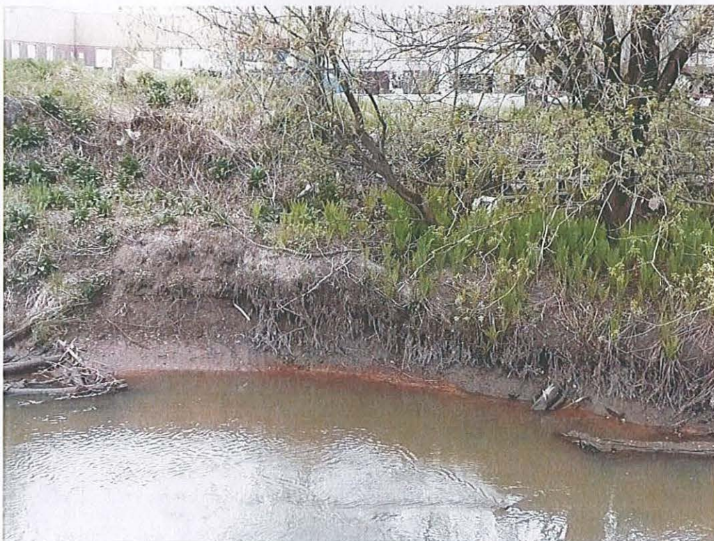
Photo 4.6 : Érosion de la rive
