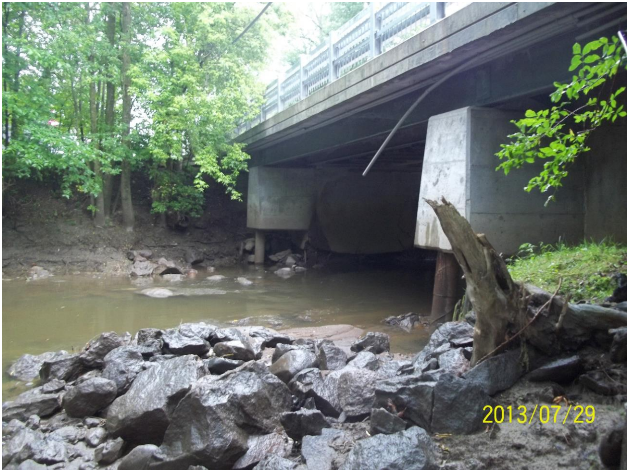
Figure B2-6A2 Pont du boulevard Masson. Érosion sous les culées.
