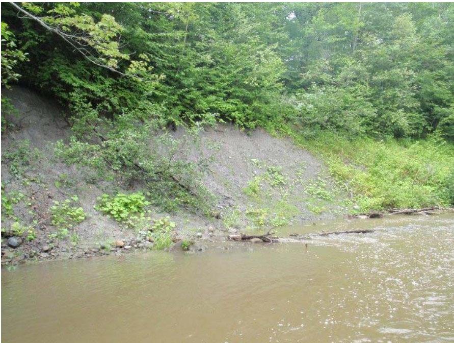
Photo 72 : Vue générale de la zone d'érosion ER-042 de la rivière Lorette.
