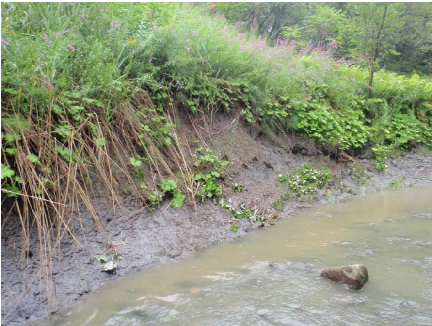
Photo 106 : Vue générale de la zone d'érosion ER-ND-13 du ruisseau Notre-Dame.
