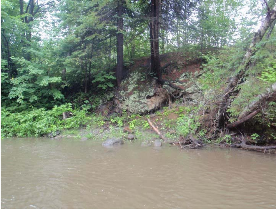
Photo 69 : Vue générale de la zone d'érosion ER-039 de la rivière Lorette.
