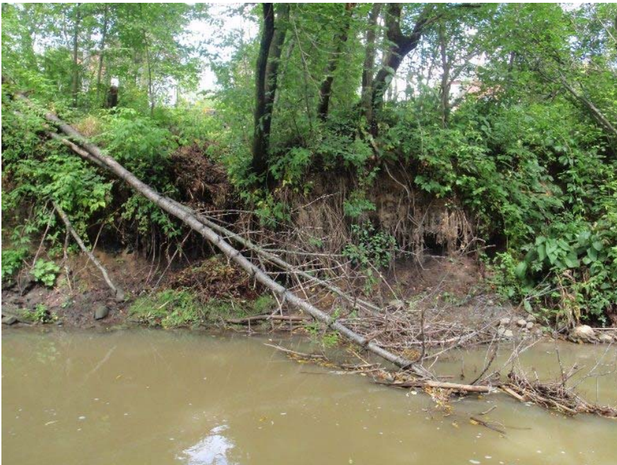
Photo 94 : Vue générale de la zone d'érosion ER-069 de la rivière Lorette.
