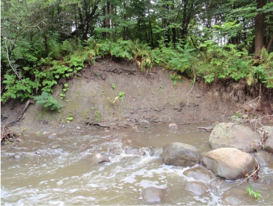
Photo 45 : Vue générale de la zone d'érosion ER-015 de la rivière Lorette.
