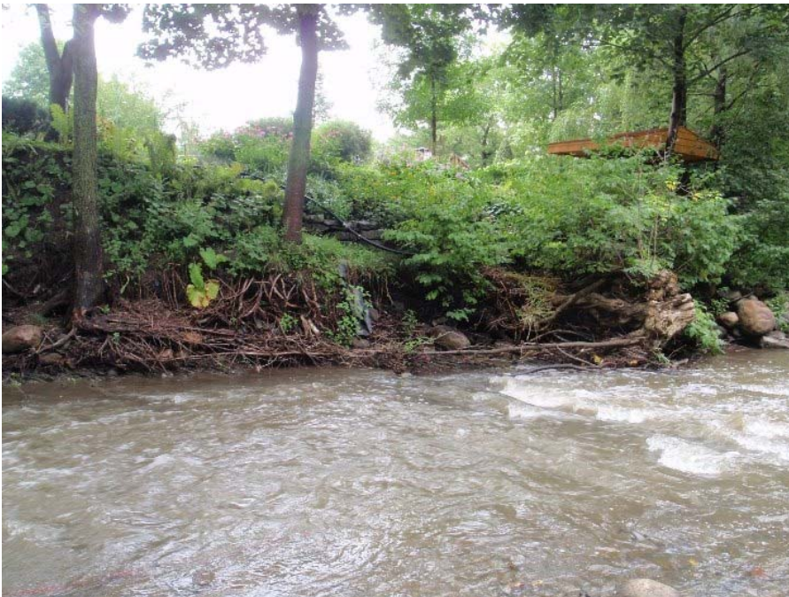
Photo 42 : Vue générale de la zone d'érosion ER-012 de la rivière Lorette.
