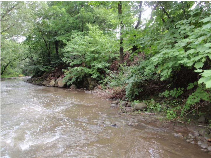
Photo 44 : Vue générale de la zone d'érosion ER-014 de la rivière Lorette.
