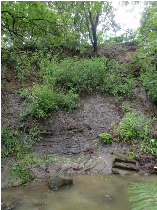
Photo 116 : Vue générale de la zone d'érosion ER-ND-24 du ruisseau Notre-Dame.
