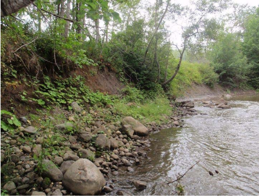
Photo 57 : Vue générale de la zone d'érosion ER-027 de la rivière Lorette.
