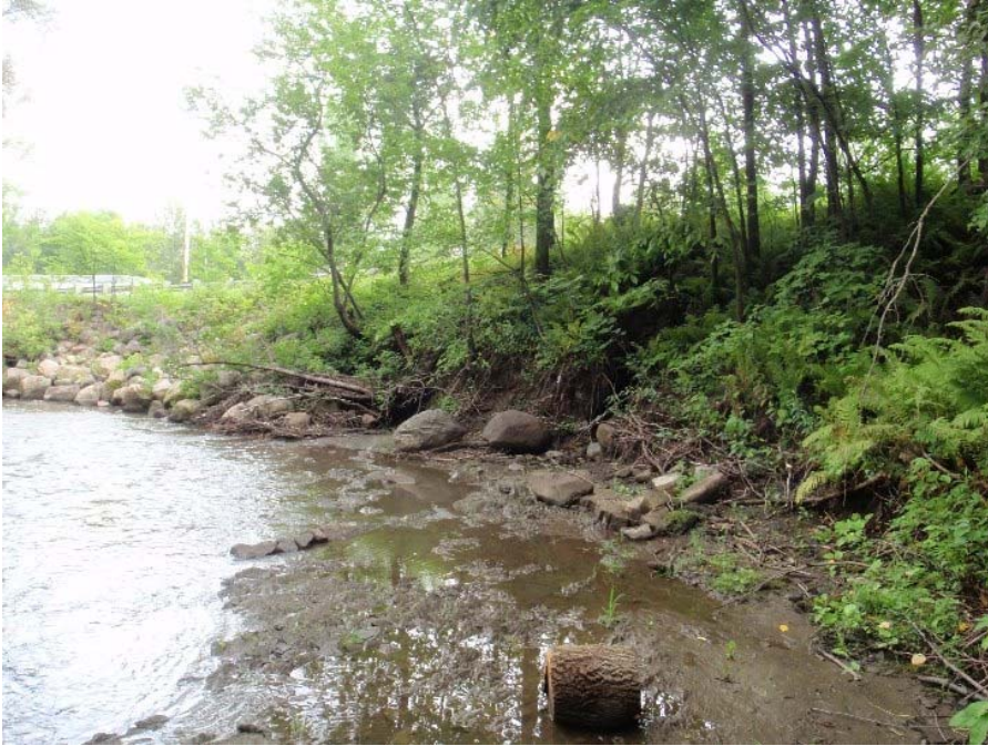
Photo 49 : Vue générale de la zone d'érosion ER-019 de la rivière Lorette.
