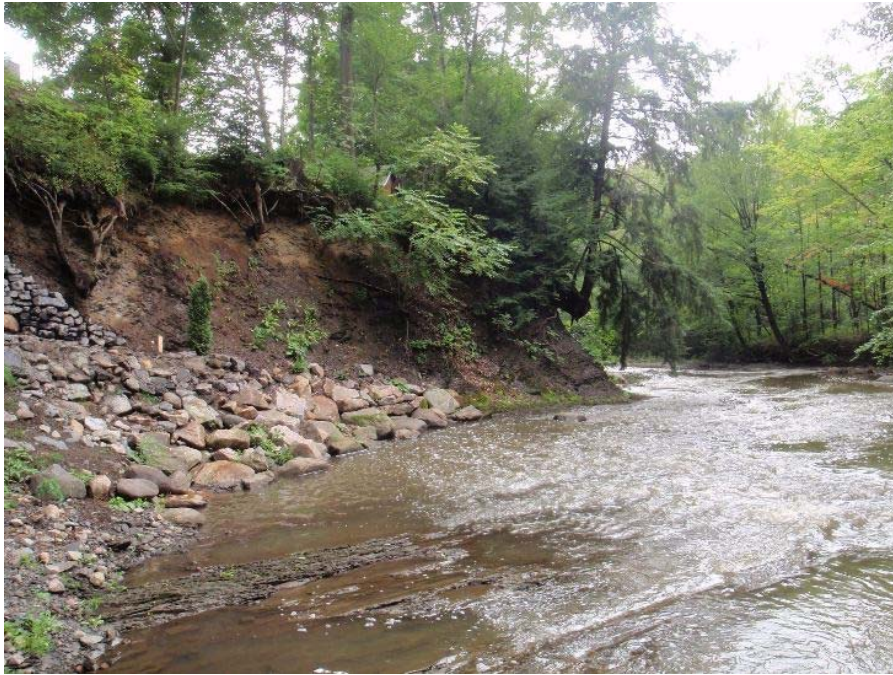
Photo 51 : Vue générale de la zone d'érosion ER-021 de la rivière Lorette.
