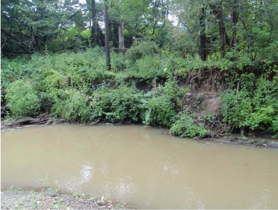
Photo 93 : Vue générale de la zone d'érosion ER-068 de la rivière Lorette.
