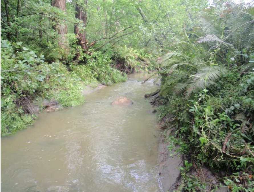
Photo 115 : Vue générale de la zone d'érosion ER-ND-23 du ruisseau Notre-Dame.
