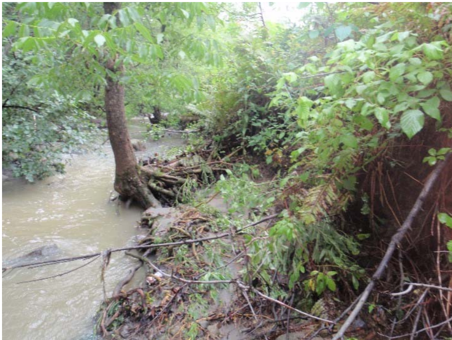
Photo 98 : Vue générale de la zone d'érosion ER-ND-2 du ruisseau Notre-Dame.
