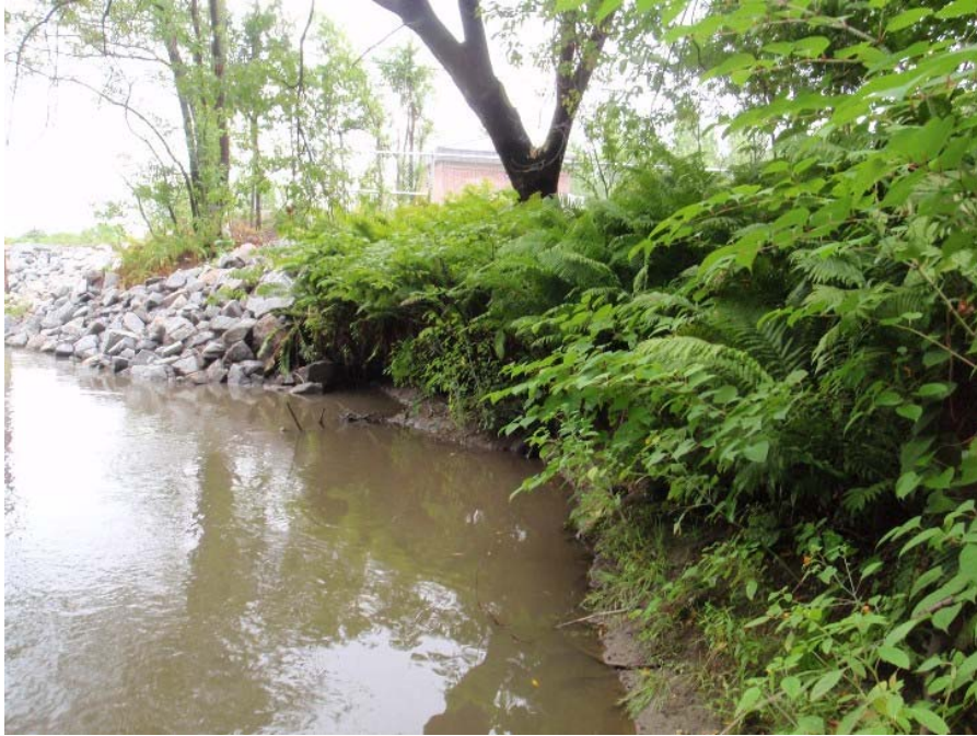
Photo 33 : Vue générale de la zone d'érosion ER-03 de la rivière Lorette.
