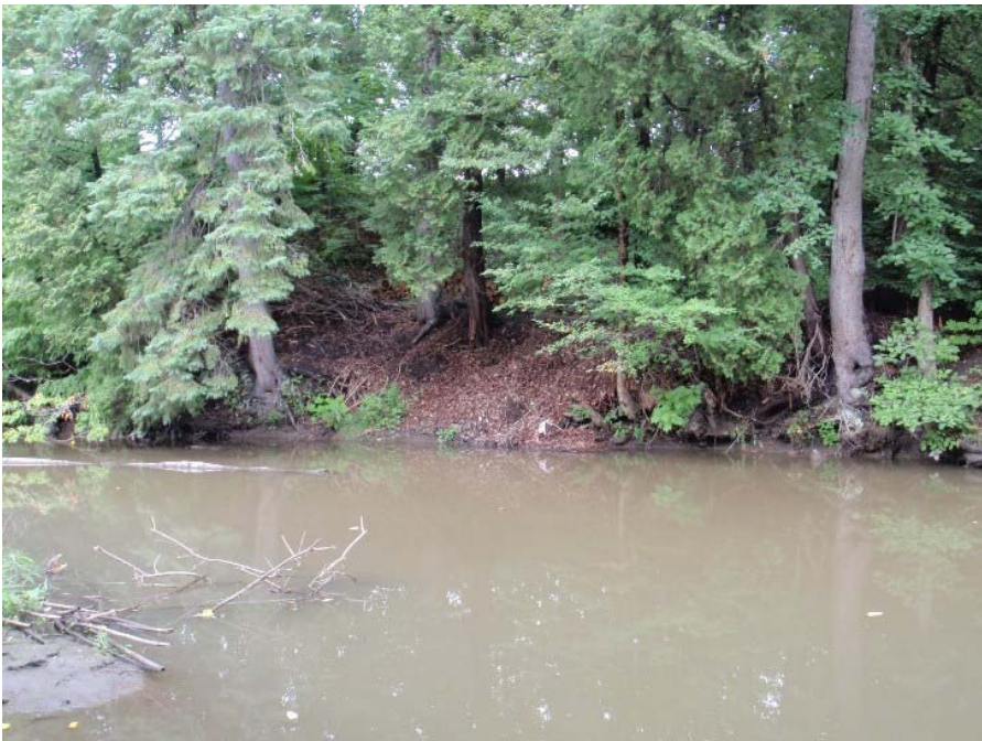
Photo 54 : Vue générale de la zone d'érosion ER-024 de la rivière Lorette.
