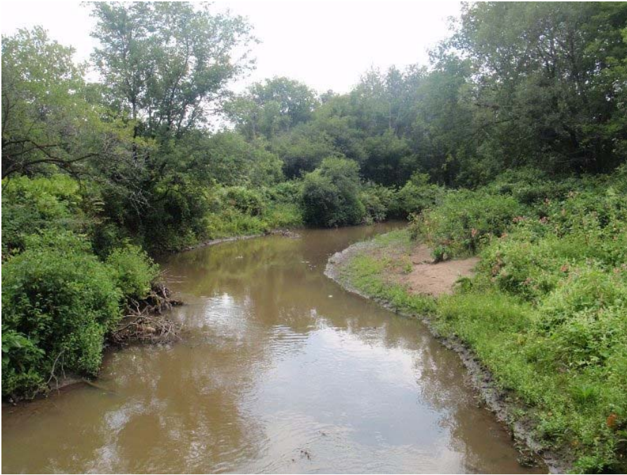
Photo 85 : Vue générale de la zone d'érosion ER-060 de la rivière Lorette.
