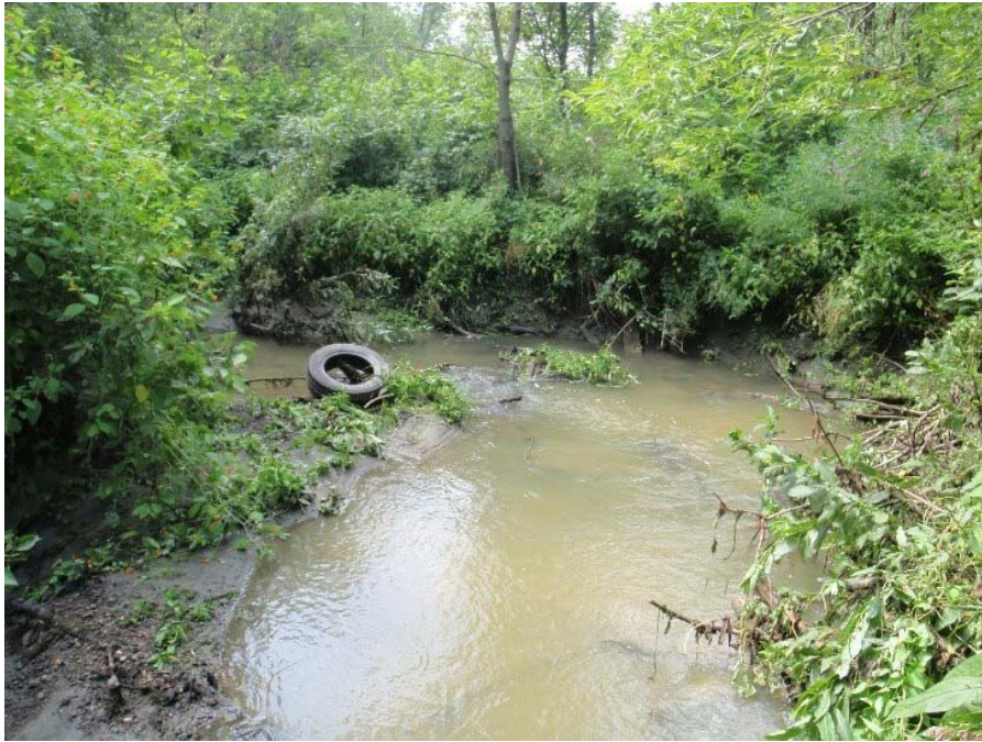
Photo 127 : Vue générale de la zone d'érosion ER-ND-36 du ruisseau Notre-Dame.
