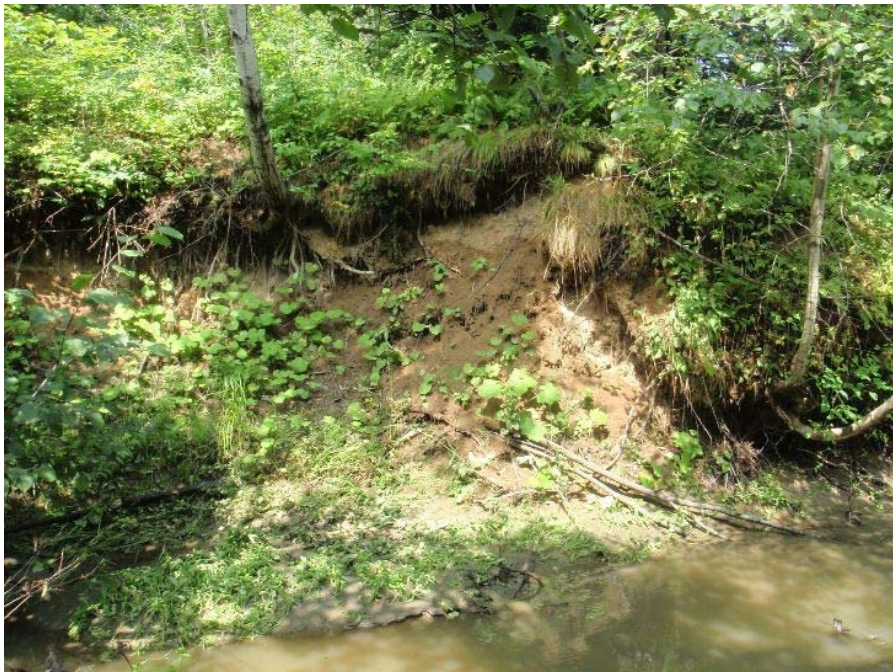
Photo 128 : Vue générale de la zone d'érosion ER-ND-37 du ruisseau Notre-Dame.
