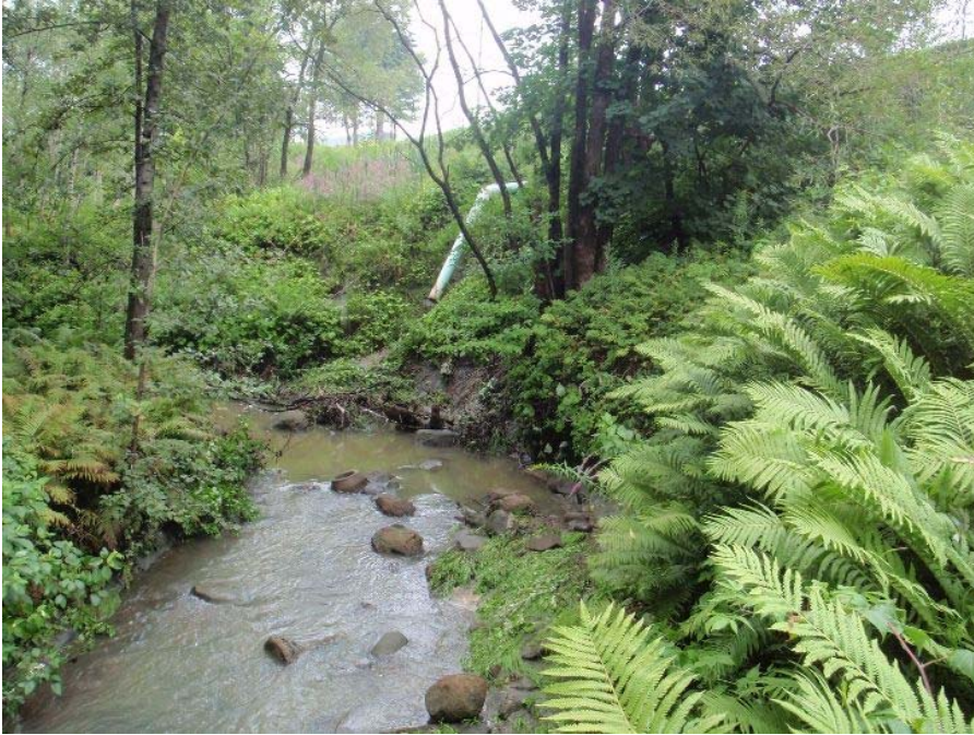
Photo 111 : Vue générale de la zone d'érosion ER-ND-19 du ruisseau Notre-Dame et de l'exutoire EX-ND-3.
