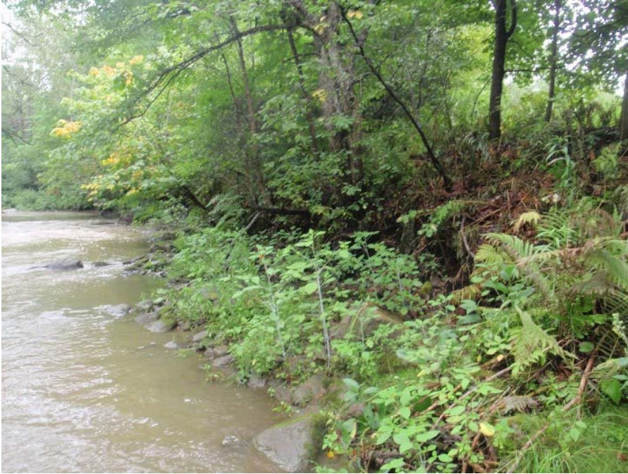
Photo 73 : Vue générale de la zone d'érosion ER-044 de la rivière Lorette.
