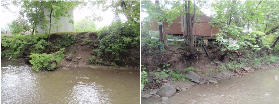
Photo 35 : Vue générale de la zone d'érosion ER-05 de la rivière Lorette.
