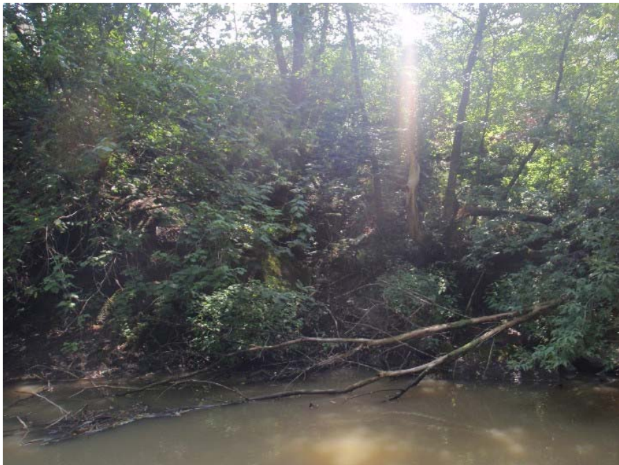
Photo 92 : Vue générale de la zone d'érosion ER-067 de la rivière Lorette.
