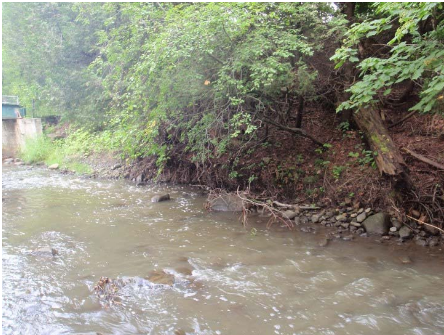
Photo 62 : Vue générale de la zone d'érosion ER-032 de la rivière Lorette.
