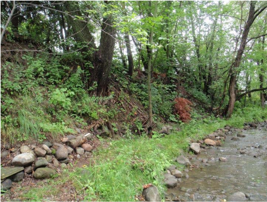
Photo 41 : Vue générale de la zone d'érosion ER-011 de la rivière Lorette.
