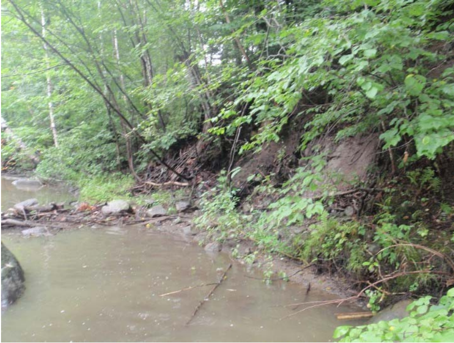
Photo 75 : Vue générale de la zone d'érosion ER-046 de la rivière Lorette.
