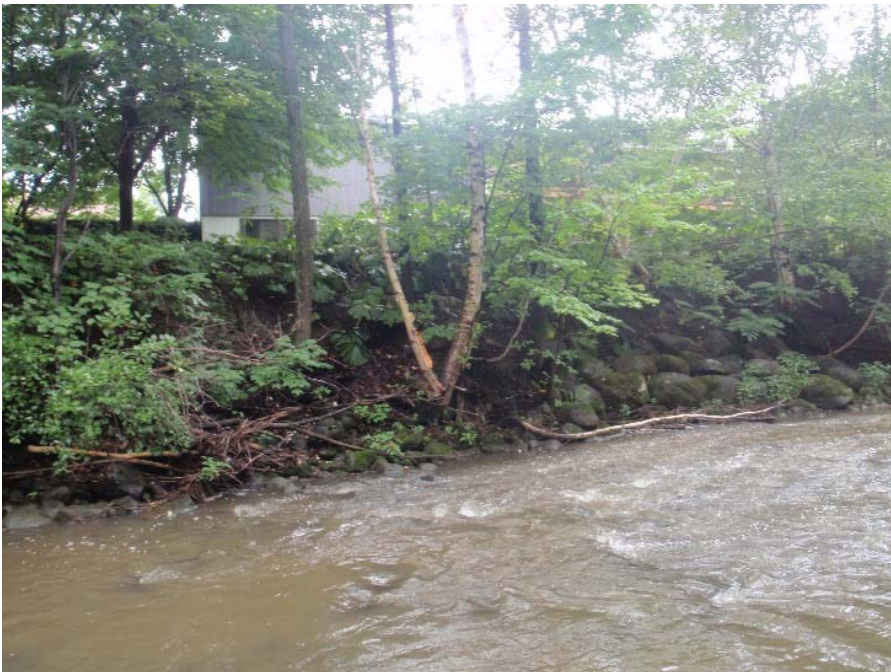
Photo 78 : Vue générale de la zone d'érosion ER-049 de la rivière Lorette.
