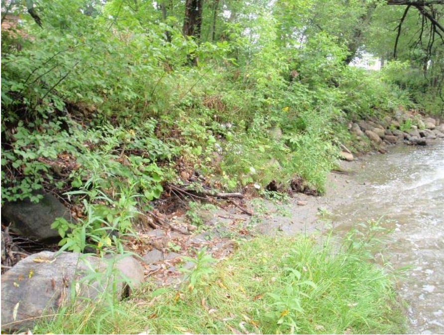
Photo 39 : Vue générale de la zone d'érosion ER-09 de la rivière Lorette.
