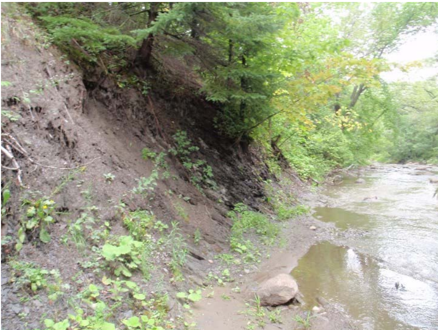
Photo 46 : Vue générale de la zone d'érosion ER-016 de la rivière Lorette.
