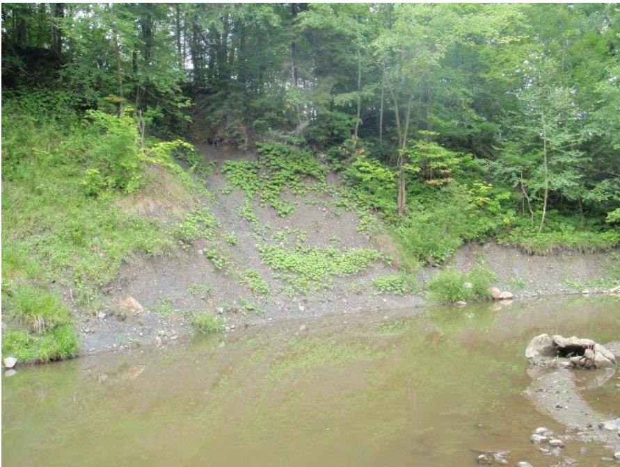
Photo 60 : Vue générale de la zone d'érosion ER-030 de la rivière Lorette.
