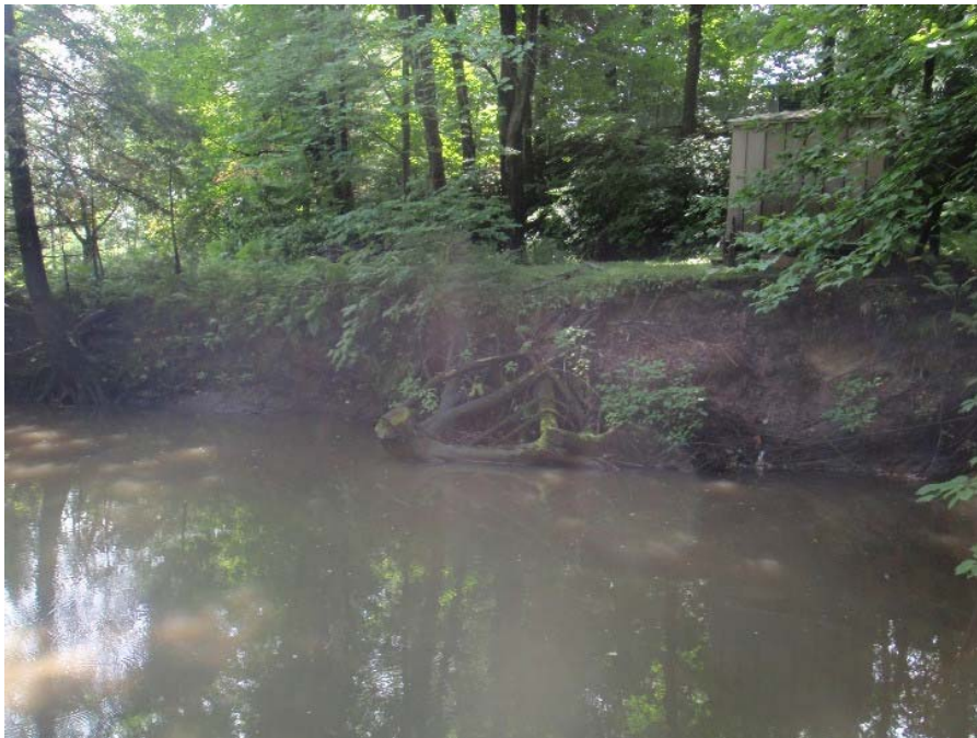
Photo 82 : Vue générale de la zone d'érosion ER-057 de la rivière Lorette.
