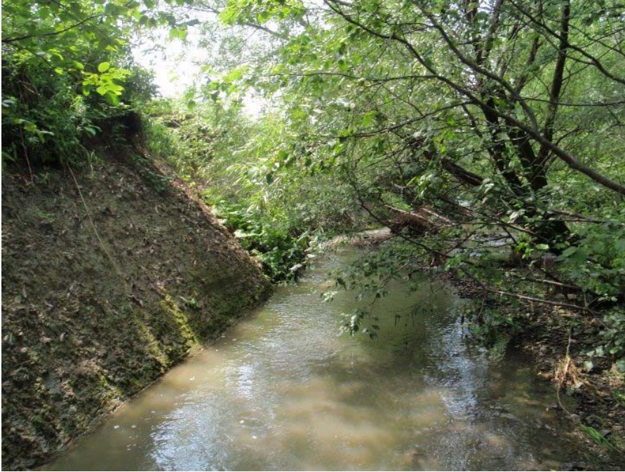
Photo 129 : Vue générale de la zone d'érosion ER-ND-38 du ruisseau Notre-Dame.
