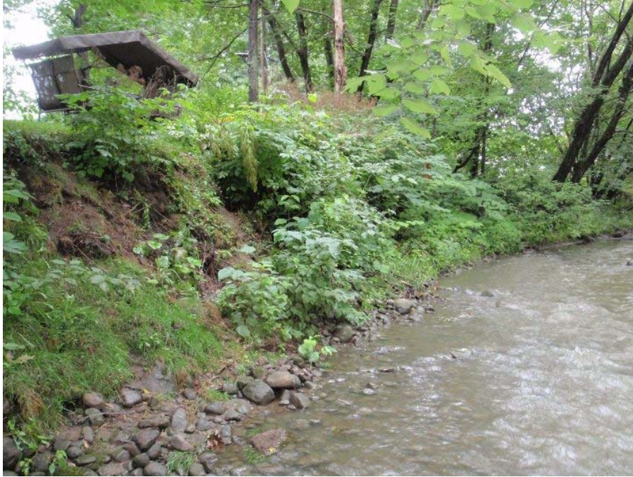
Photo 37 : Vue générale de la zone d'érosion ER-07 de la rivière Lorette.
