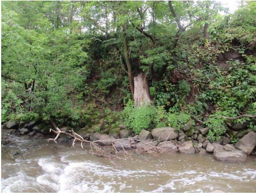
Photo 47 : Vue générale de la zone d'érosion ER-017 de la rivière Lorette.
