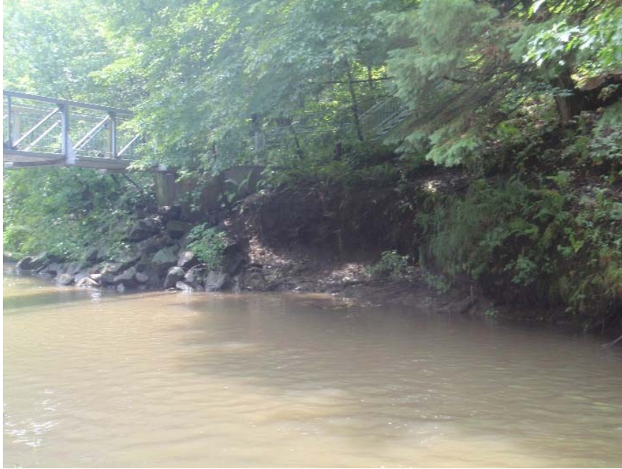
Photo 81 : Vue générale de la zone d'érosion ER-055 de la rivière Lorette.
