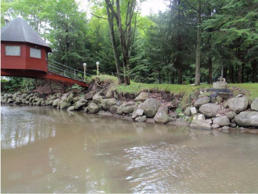
Photo 53 : Vue générale de la zone d'érosion ER-023 de la rivière Lorette.
