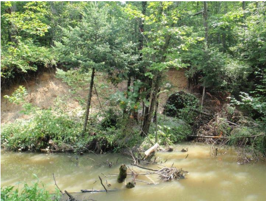
Photo 126 : Vue générale de la zone d'érosion ER-ND-35 du ruisseau Notre-Dame.
