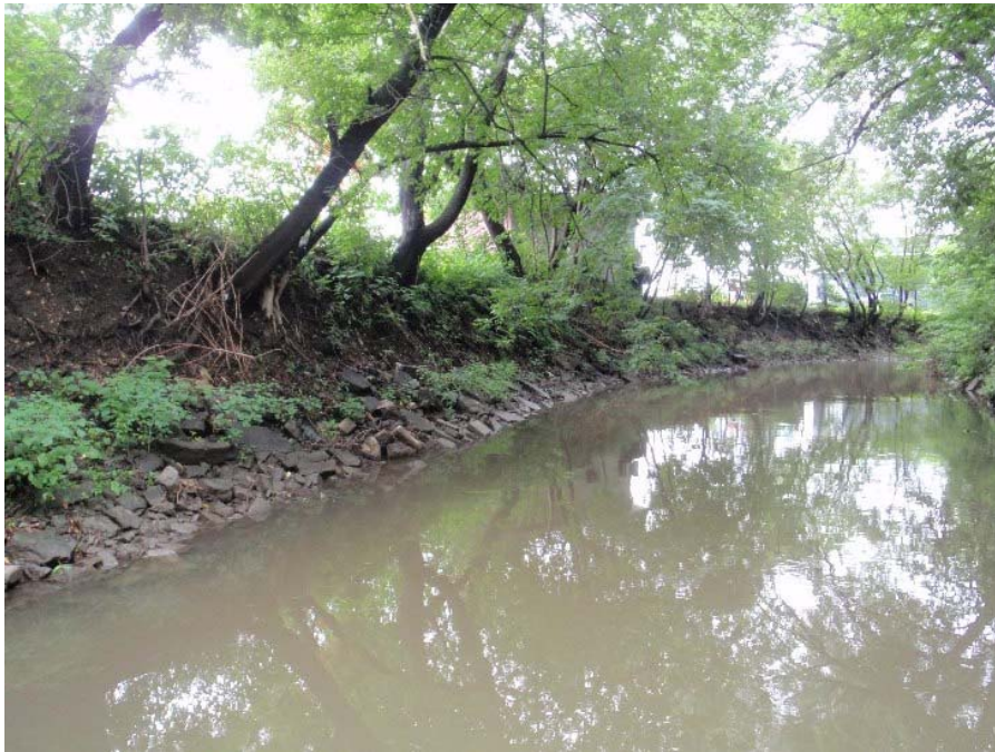
Photo 36 : Vue générale de la zone d'érosion ER-06 de la rivière Lorette.
