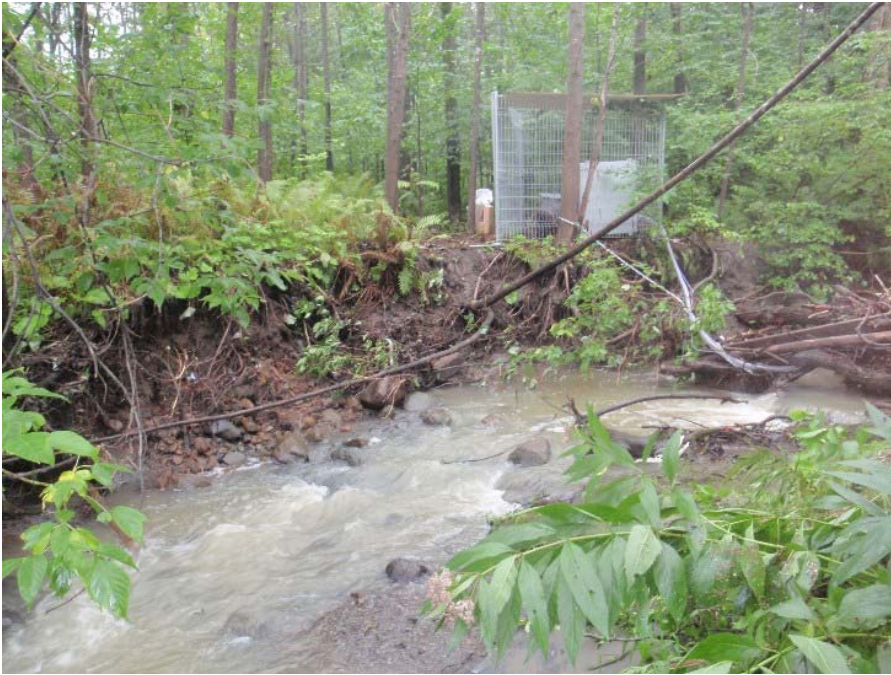
Photo 101 : Vue générale de la zone d'érosion ER-ND-5 du ruisseau Notre-Dame.
