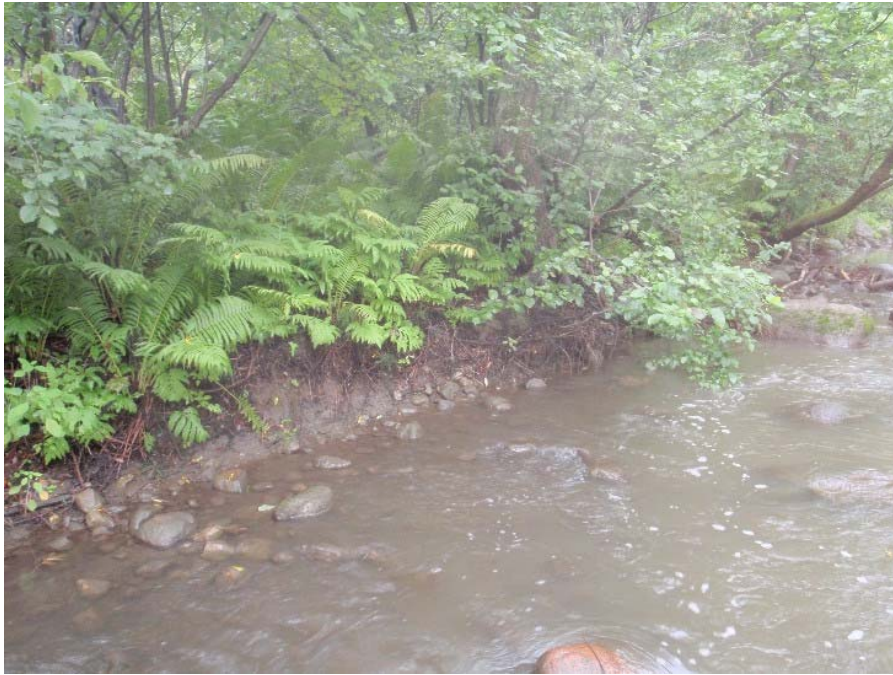
Photo 63 : Vue générale de la zone d'érosion ER-033 de la rivière Lorette.
