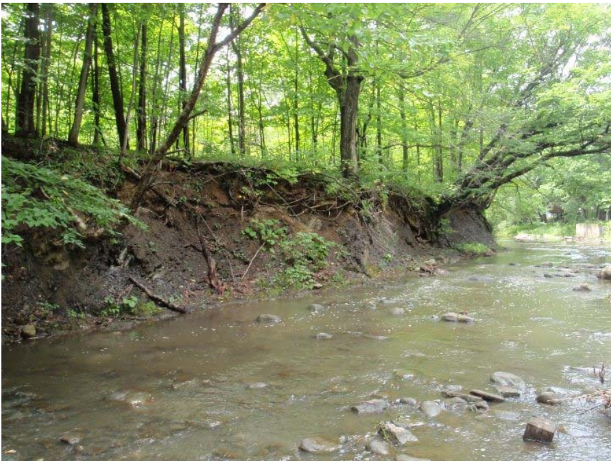
Photo 50 : Vue générale de la zone d'érosion ER-020 de la rivière Lorette.
