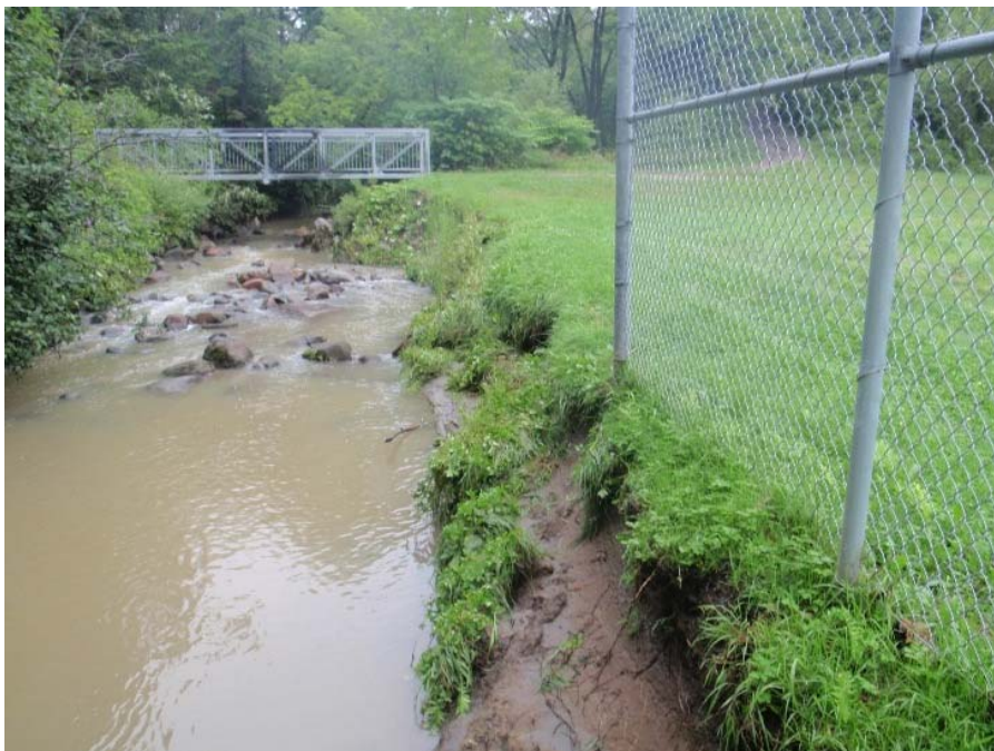
Photo 100 : Vue générale de la zone d'érosion ER-ND-4 du ruisseau Notre-Dame.
