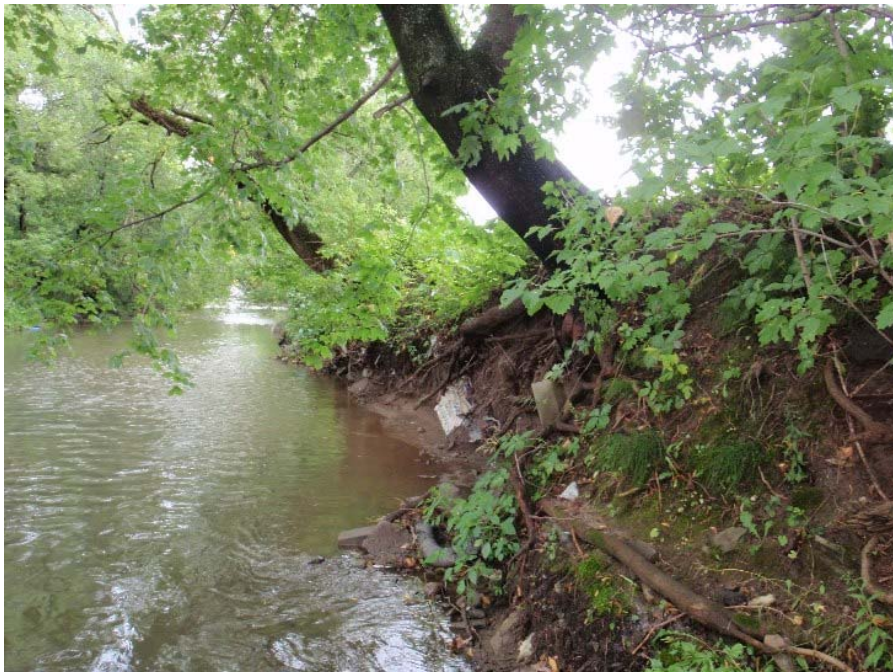
Photo 34 : Vue générale de la zone d'érosion ER-04 de la rivière Lorette.
