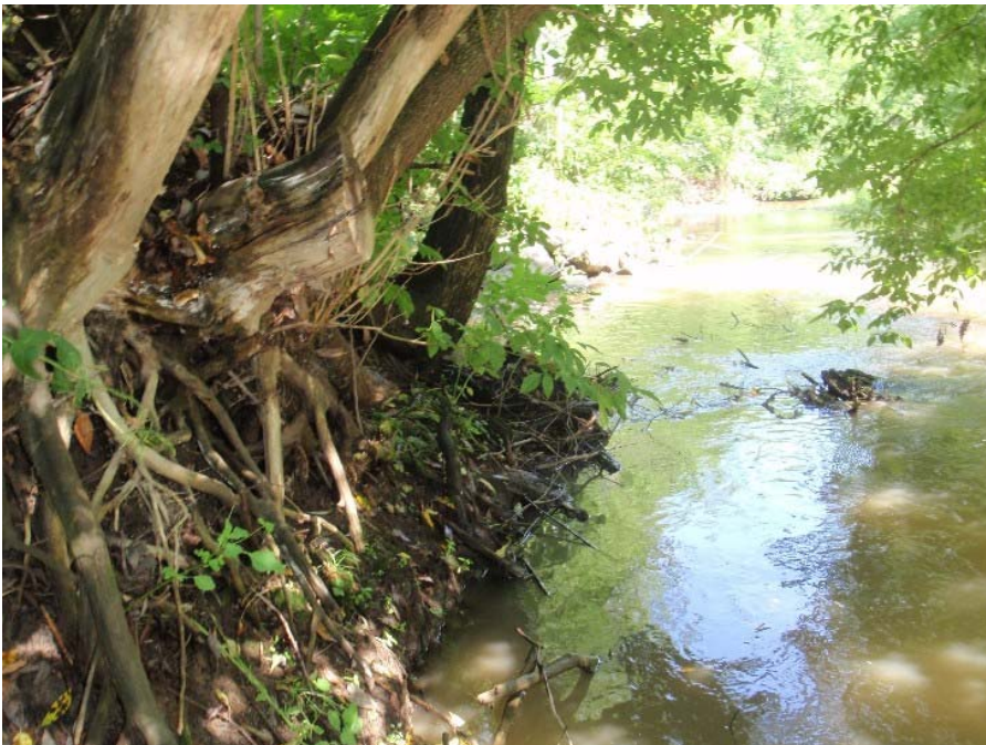
Photo 90 : Vue générale de la zone d'érosion ER-065 de la rivière Lorette.
