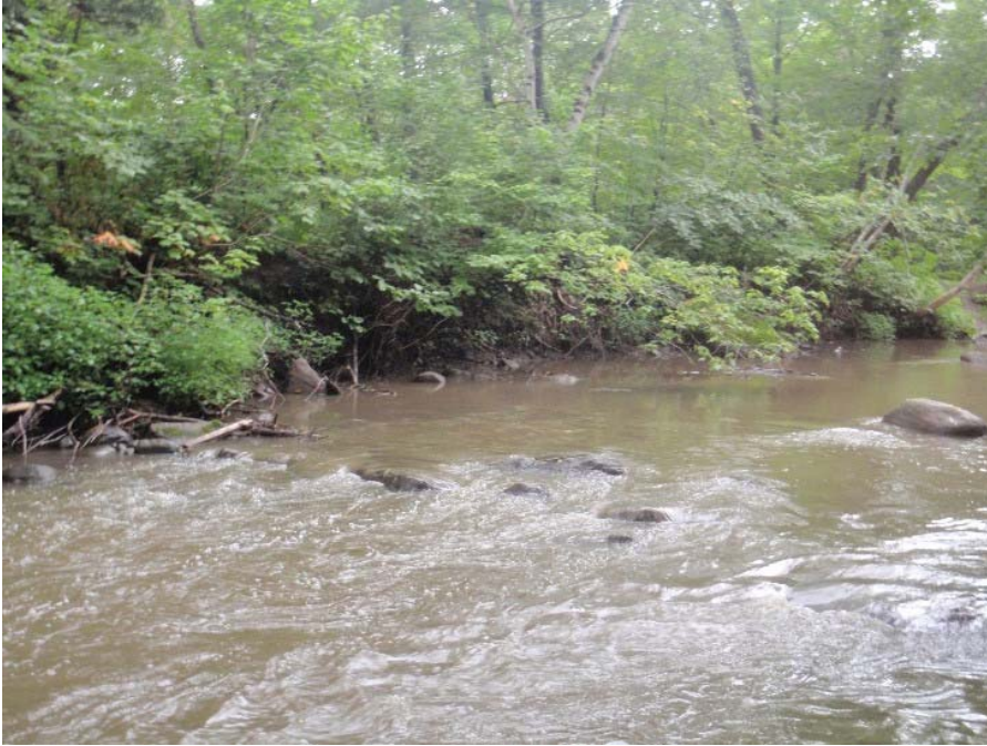
Photo 77 : Vue générale de la zone d'érosion ER-048 de la rivière Lorette.
