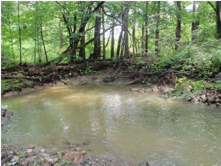
Photo 120 : Vue générale de la zone d'érosion ER-ND-29 du ruisseau Notre-Dame.
