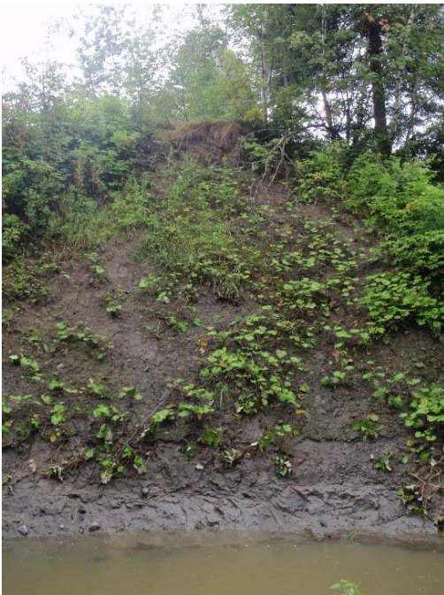
Photo 108 : Vue générale de la zone d'érosion ER-ND-16 du ruisseau Notre-Dame.
