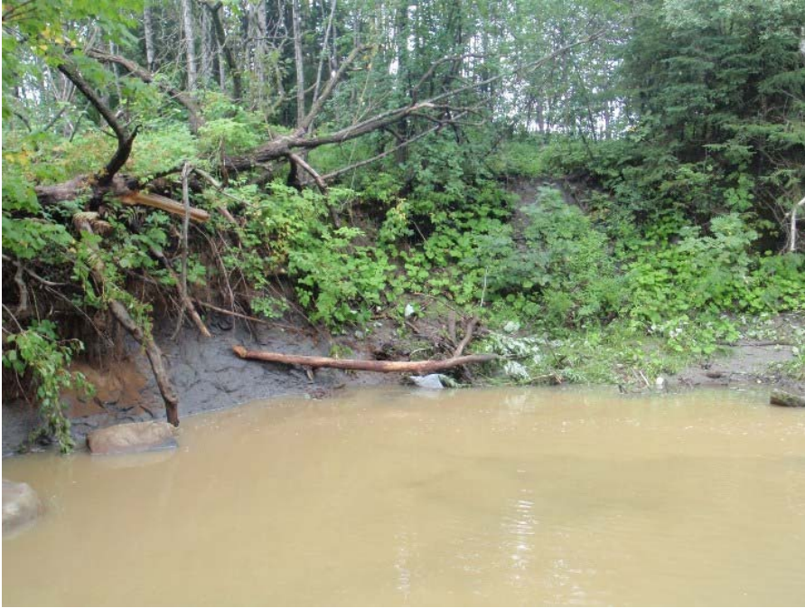
Photo 113 : Vue générale de la zone d'érosion ER-ND-21 du ruisseau Notre-Dame.
