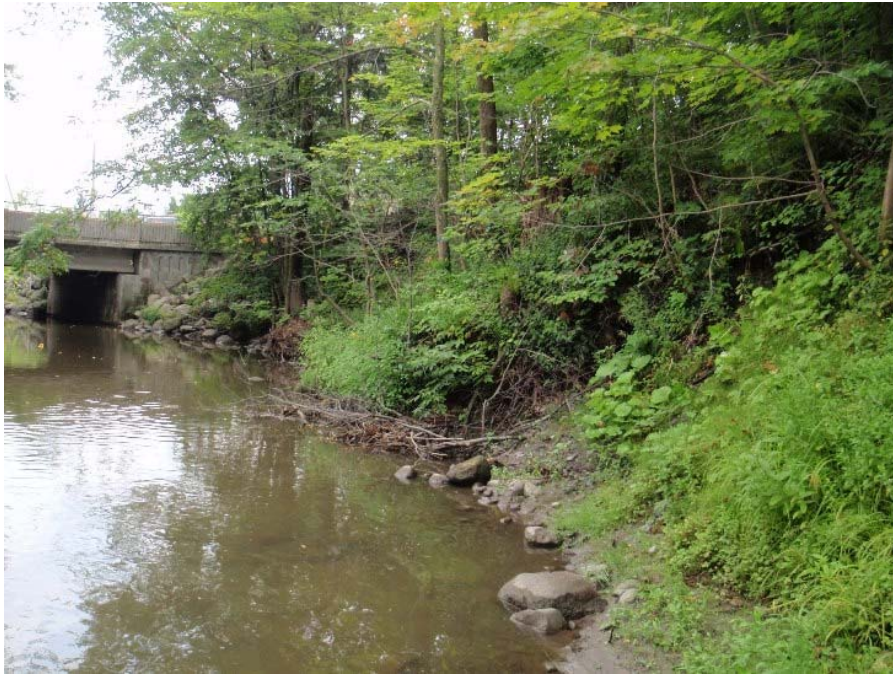
Photo 55 : Vue générale de la zone d'érosion ER-025 de la rivière Lorette.
