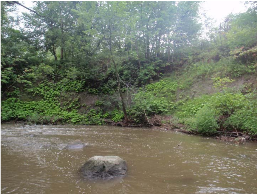
Photo 76 : Vue générale de la zone d'érosion ER-047 de la rivière Lorette.
