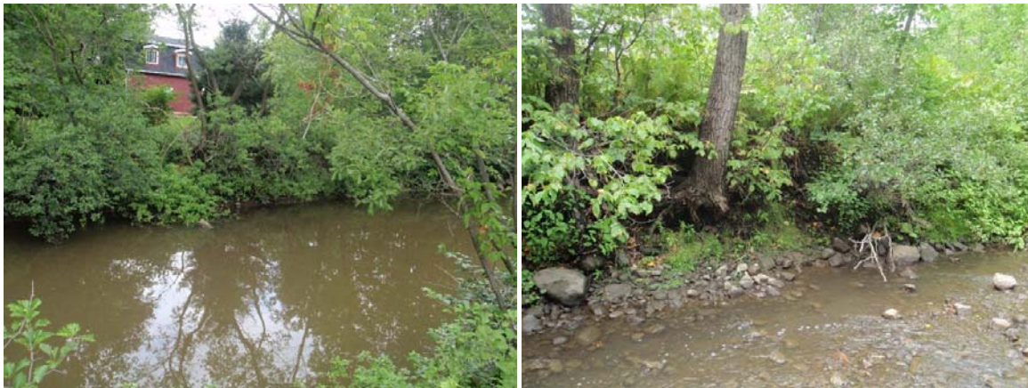
Photo 56 : Vue générale de la zone d'érosion ER-026 de la rivière Lorette.
