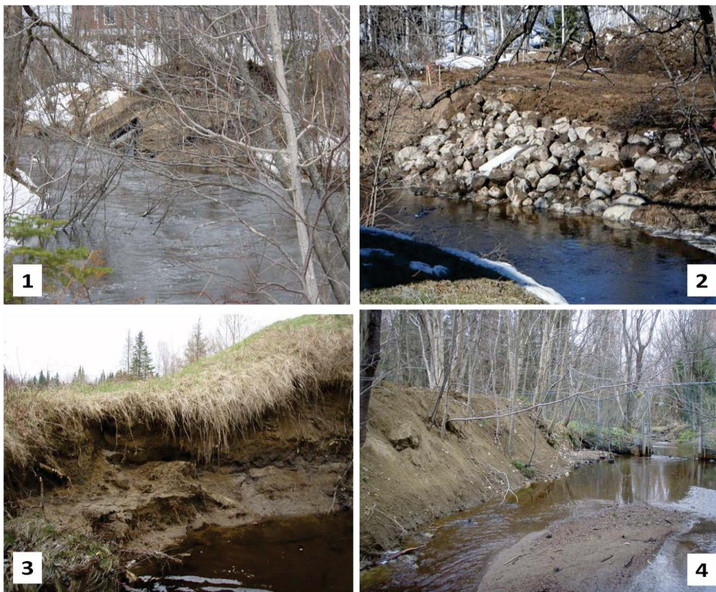
Photos 2 : Travaux sur la rue Hamon (rivière Nelson) lors de la construction d'un bassin de rétention (1); stabilisation de la berge suite à une plainte (2); érosion des berges du ruisseau Savard dans le secteur du golf désaffecté de Val-Bélair (3); remblai dans le ruisseau Savard par un particulier (4).
