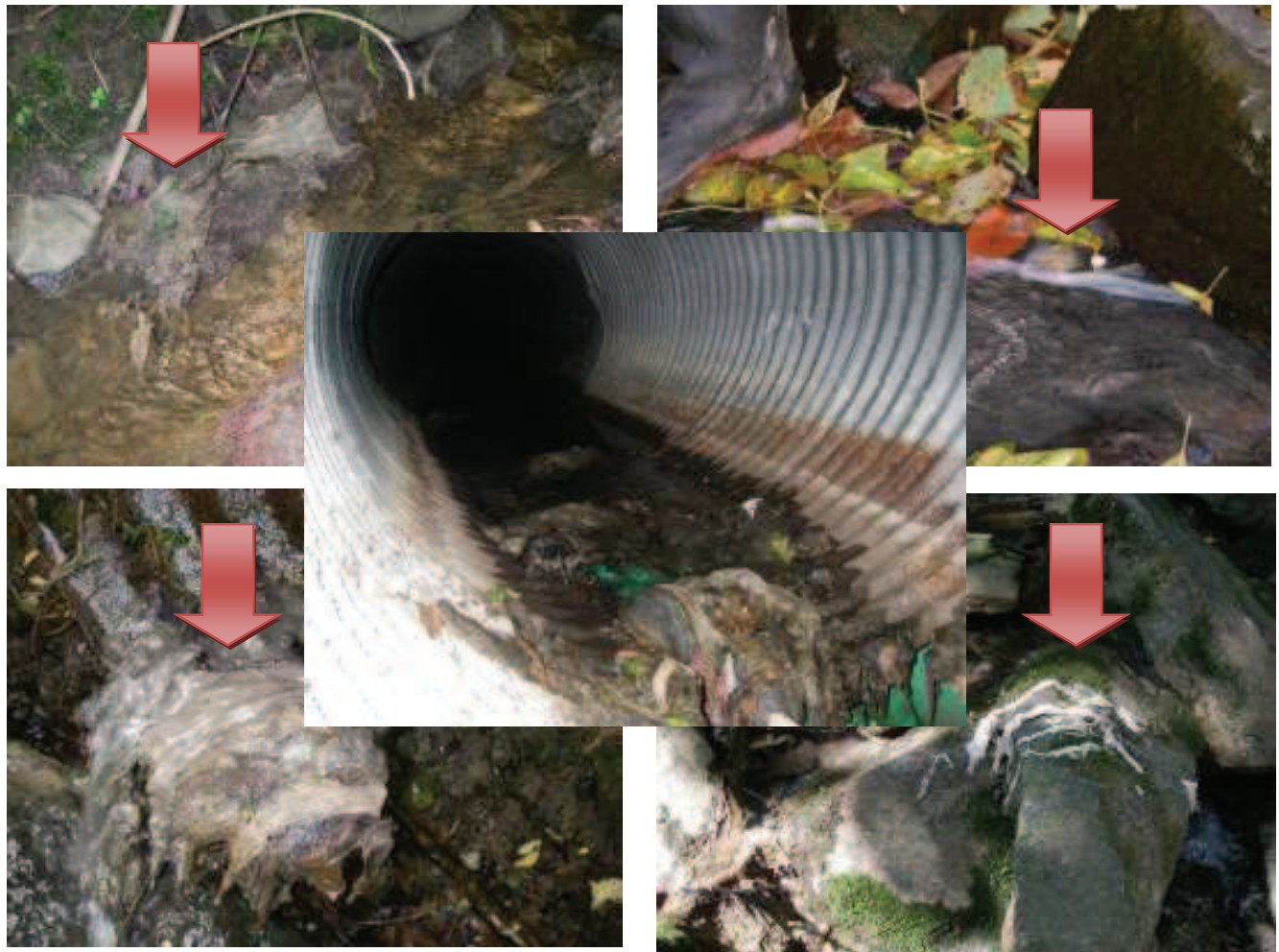
Photo 4 : Papier de toilette retrouvé aux conduites CPLO 06, CPLO10, CPLO 15, CPLO 18 et CPLO20 (2009)
