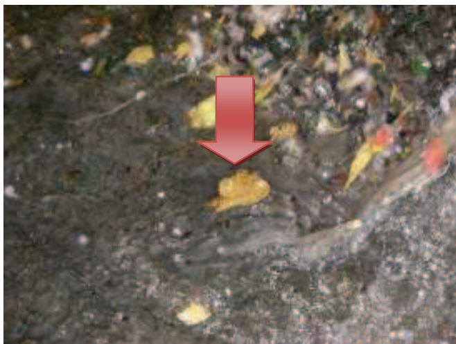
Photo 6 : Matière fécale observée à la conduite CPO 15 (juillet 2009)
