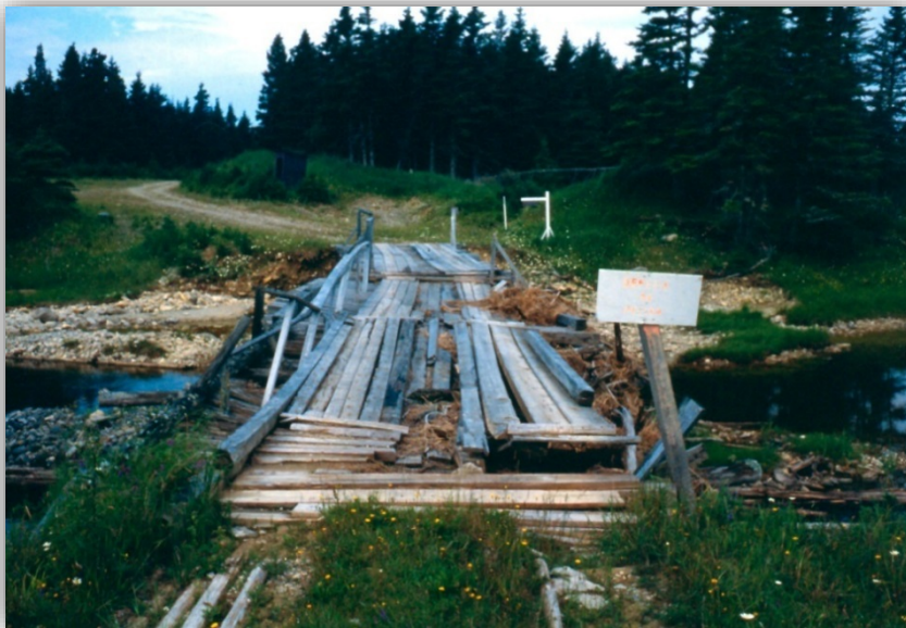
Pont à réparer Accès à un chalet privé
