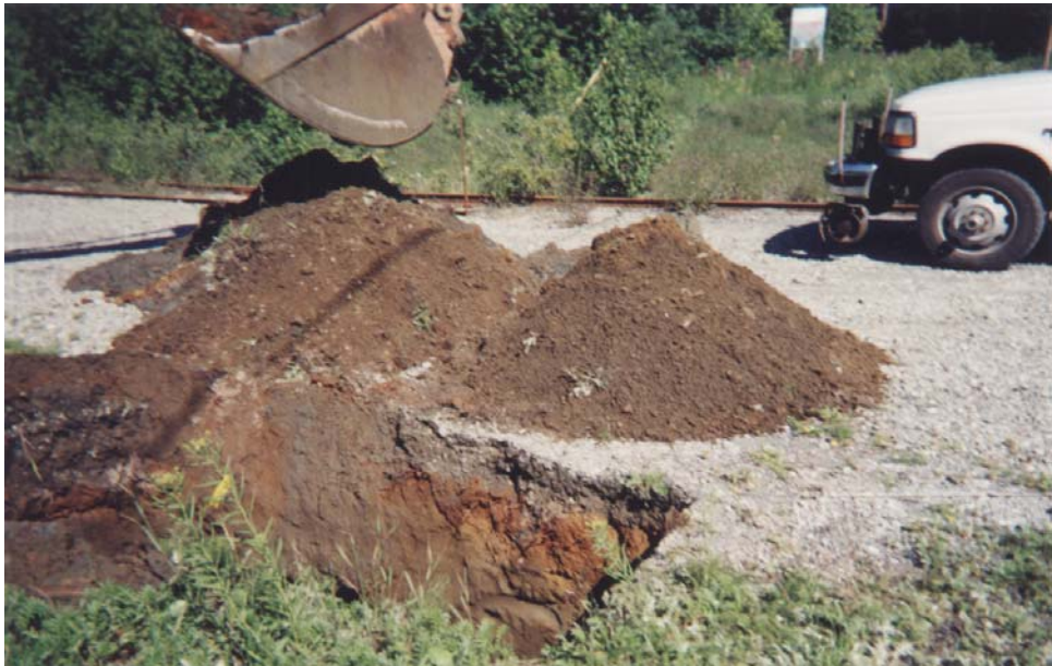
Photo 4 : Réalisation de la tranchée d'exploration TP-62 (lot 50). Un sable fin avec 20 % de cailloux et traces de morceaux de métal correspond au remblai de surface jusqu'à une profondeur de 1 m. (31-07-03)
