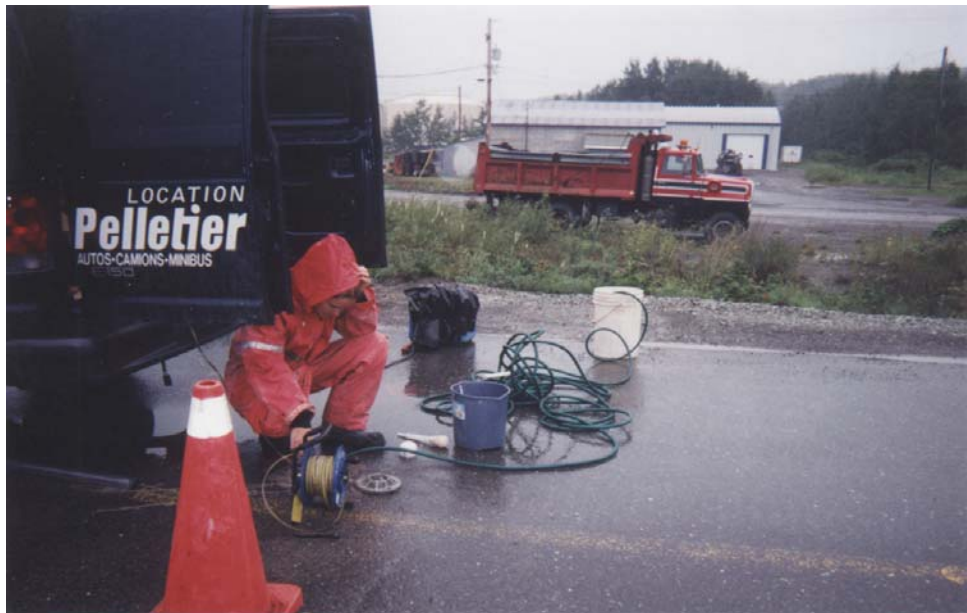
Photo 11 : Essai hydraulique sur le puits PO03-73 (lot B6-2) à l'aide d'une pompe. Prise des mesures de niveau d'eau au fur et à mesure du pompage et de la remontée. (08-08-03)
