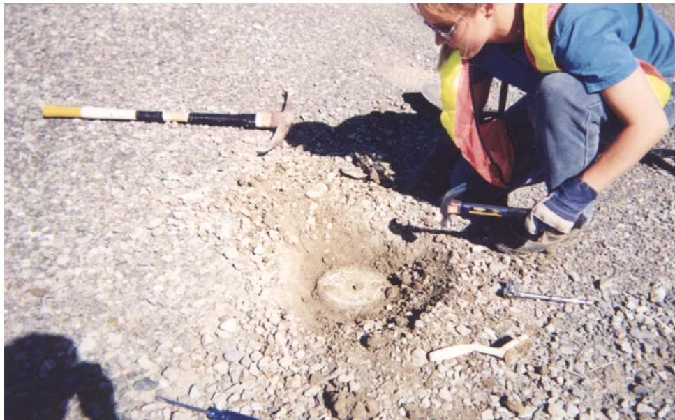
Photo 2 : Puits PO-27 retrouvé sous 0,3 m de gravier grâce au détecteur de métal. Vérification de l'état du puits, du niveau d'eau et de sa profondeur. (30-07-03)
