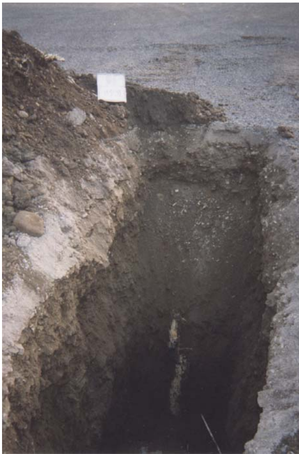
Photo 7 : Réalisation de la tranchée d'exploration TP-101 (lot 1-4). On aperçoit un pilier de bois de l'ancien quai. Le remblai qui est composé de sable avec un peu de gravier, des lentilles de silt et des traces de bois atteignant une profondeur de 3,0 m. (06-08-03)
