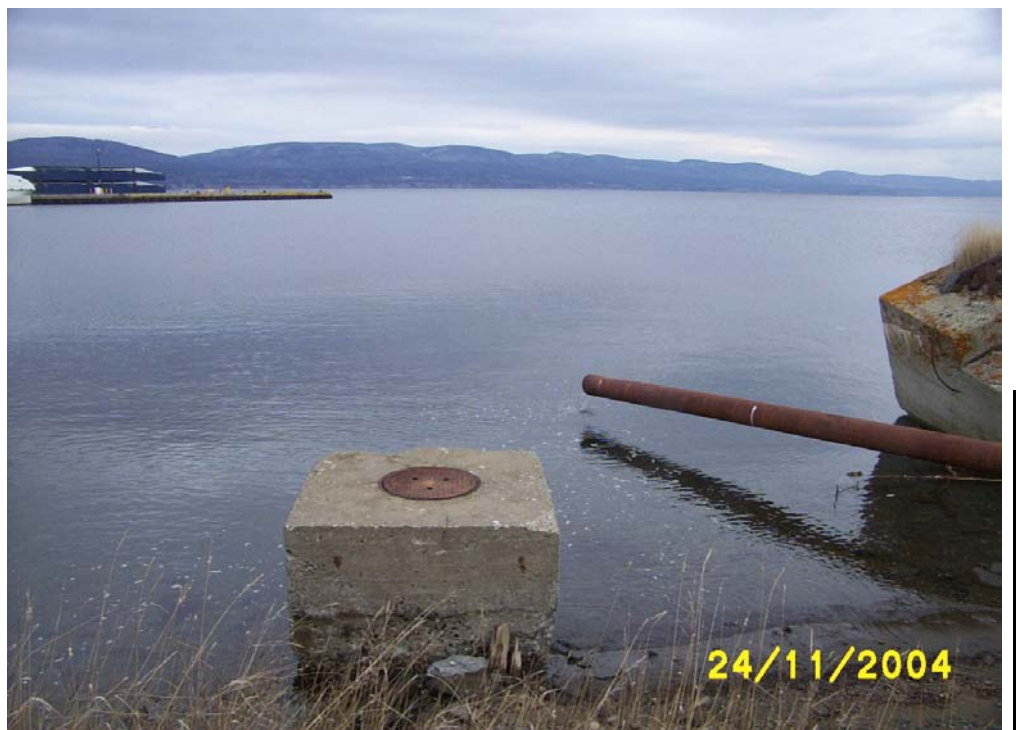
Photo n° 4. Vue vers le nord-est de l'ancien regard et de la conduite en acier d'environ 250 à 300 mm de diamètre se déversant directement dans la baie de Gaspé, directement au nord du chantier maritime.
