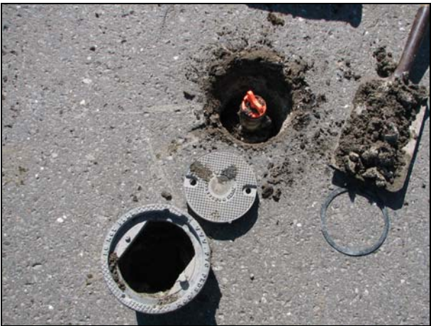
Photo 29 : Retrait de matériel pour permettre à nouveau l'installation d'une boîte de protection.
