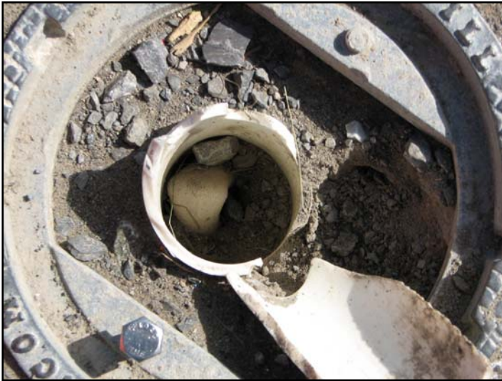
Photo 16 : État du puits d'observation PO03-75 avant les travaux de réparation. Tête de puits et tubage remplie de terre. Le puits était tout de même récupérable (pas beaucoup de dépôts au fond).
