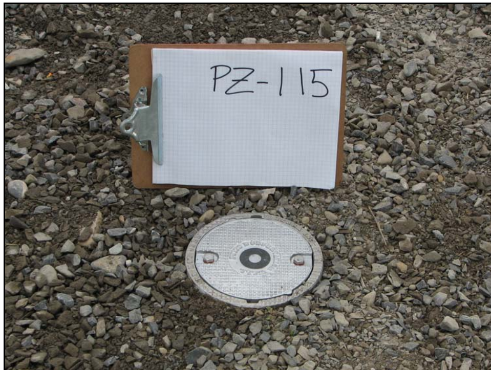
Photo 10 : Puits d'observation PZ-115 après entretien (boîte de service limitant l'accès).
