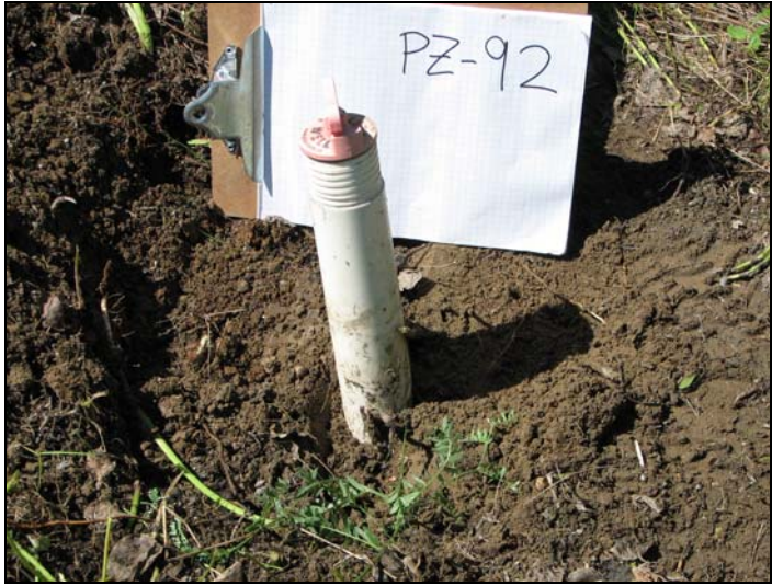
Photo 11 : État du puits d'observation PZ-92 avant les travaux de réparation.
