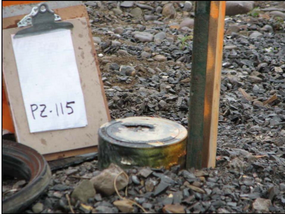
Photo 9 : Rehaussement du puits d'observation PZ-115 et fabrication d'une tête de puits par DJL.
