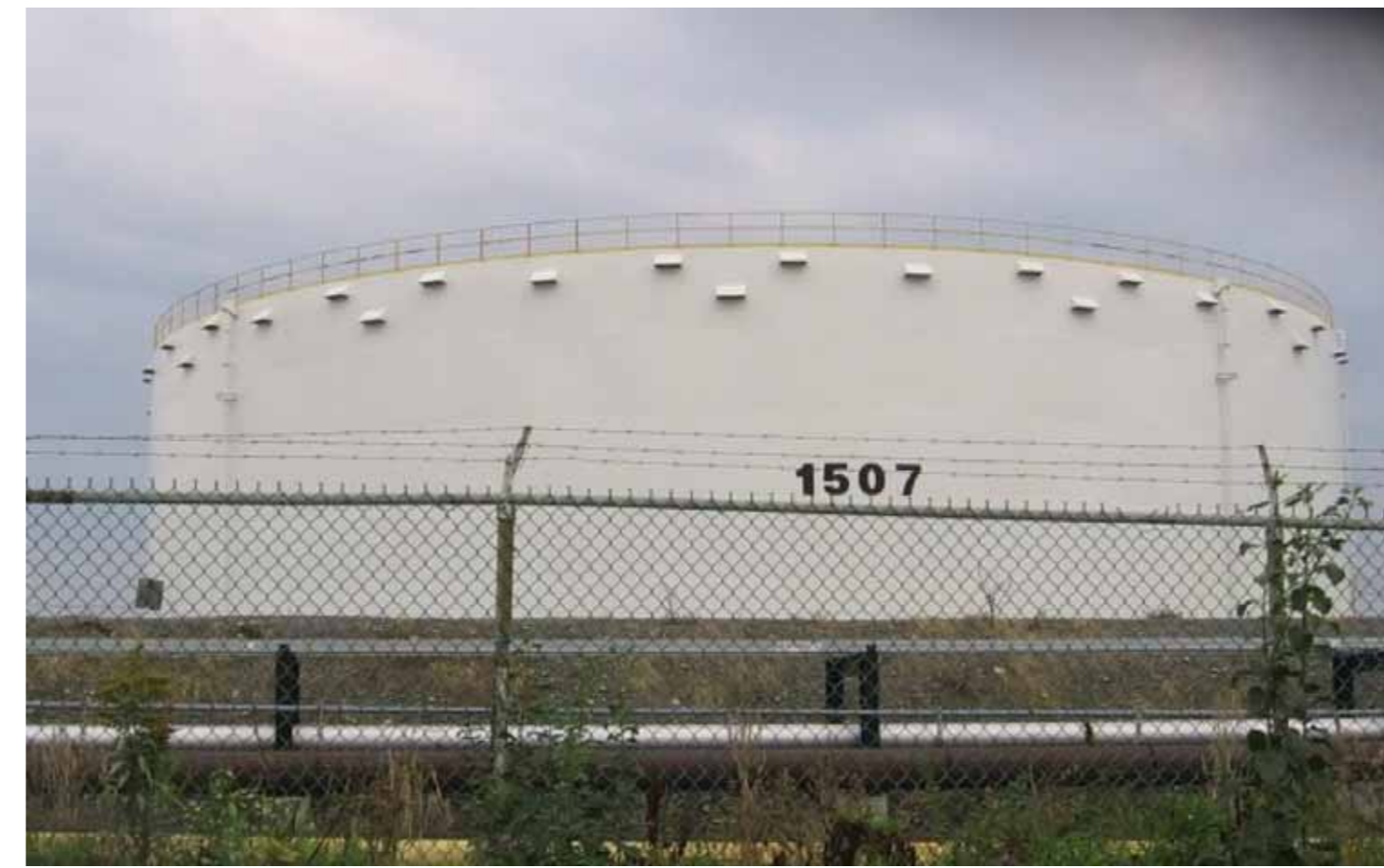
Réservoir à toit flottant interne (constituants d'essence)
