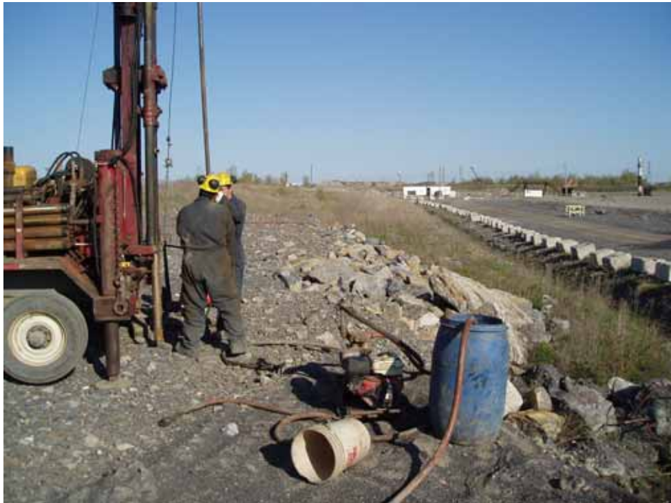
Photo 3 : Travaux de forage du sondage F-05-2 à l'extrémité « est » de la butte.
