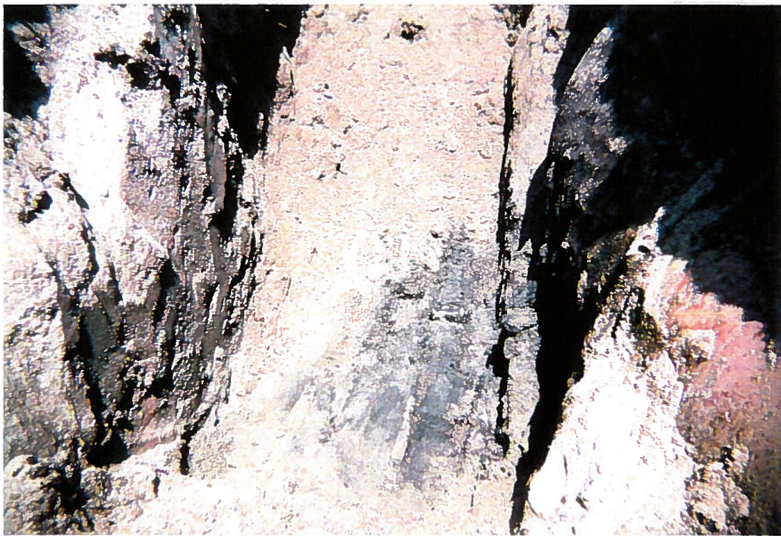
PHOTO 11 - Traces noirâtres au bas du réservoir (côté ouest)
