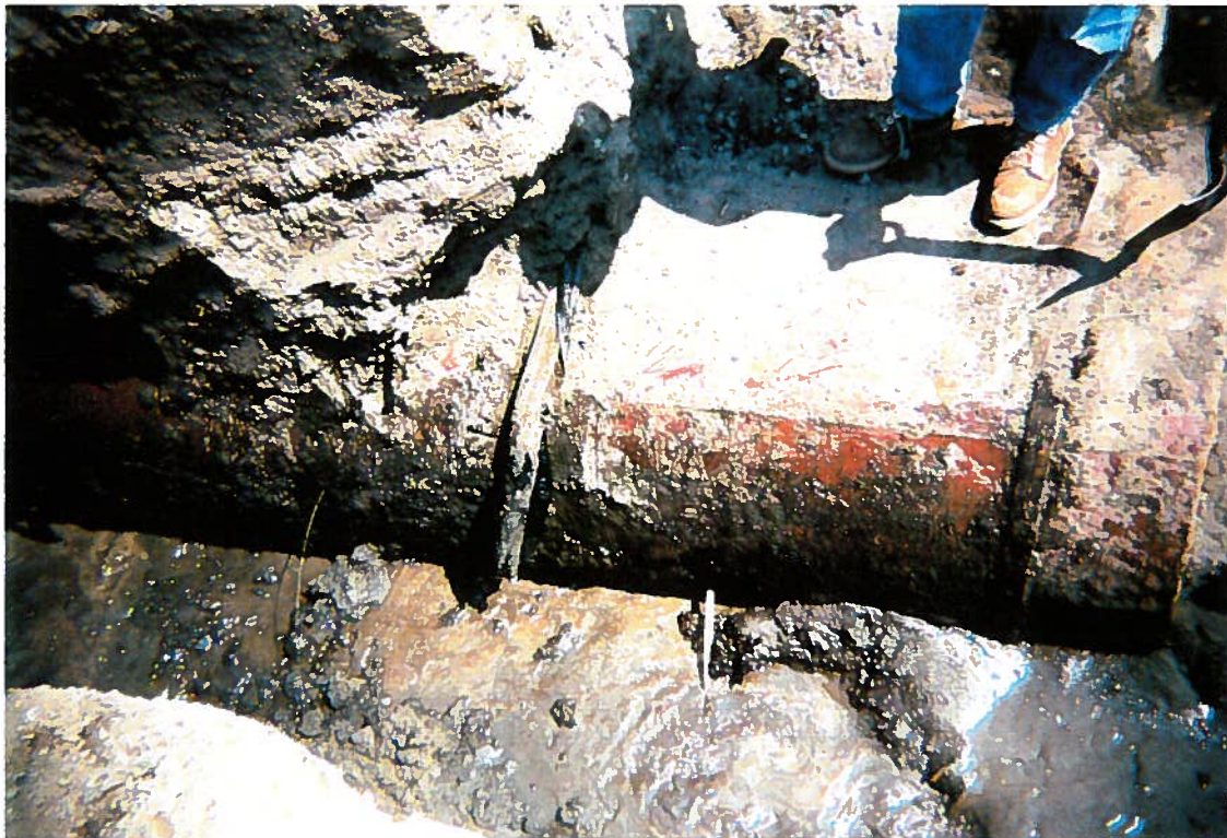
PHOTO 13 - Écoulement du réservoir
