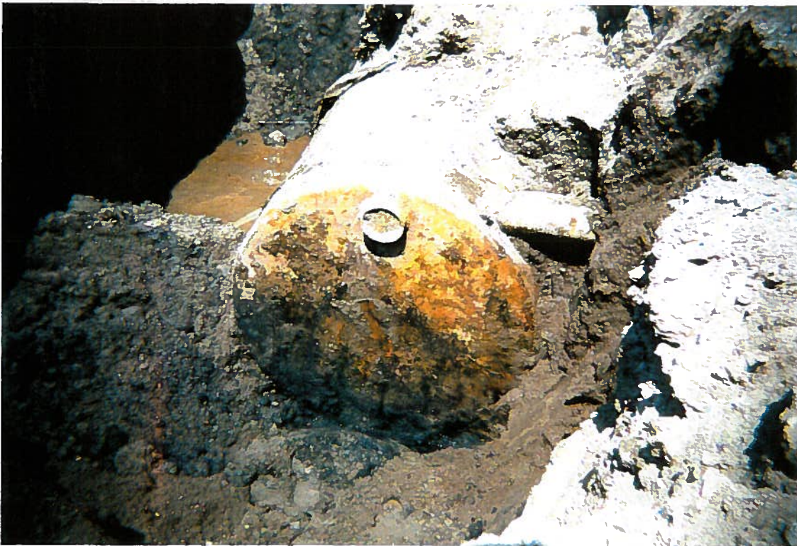
PHOTO 16 - Tête du réservoir (partie sud) et présence de matériel noirâtre
