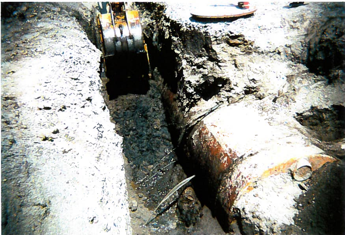
PHOTO 14 - Dégagement du réservoir et présence d'autres fuites
