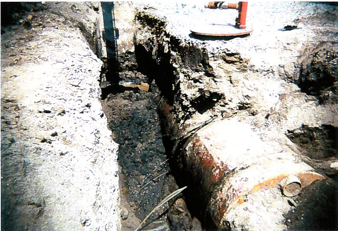
PHOTO 15 - Nombreuses perforations du réservoir
