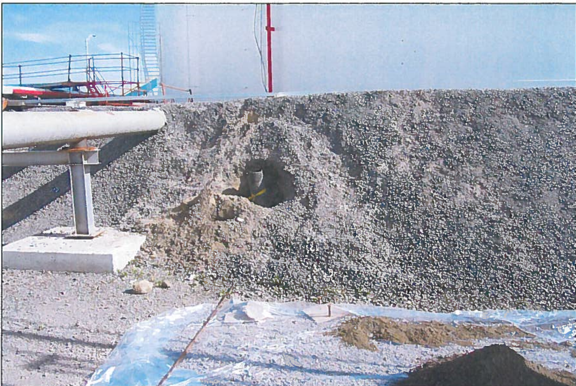
Photo 18 : Vue sur l'ancien puits F96-12 qui sera fermé de façon sécuritaire (4 mai 2009).
