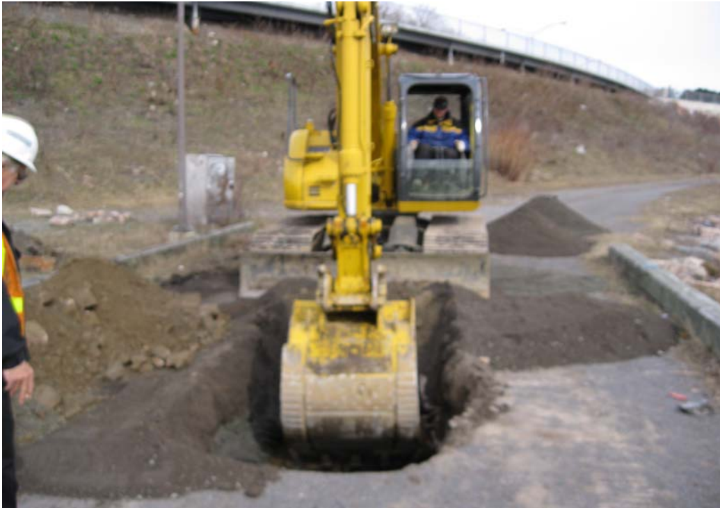
Photo 5 Réalisation de la tranchée TR2 (12 avril 2010) secteur du quai Frontenac (vue vers le nord-ouest).
