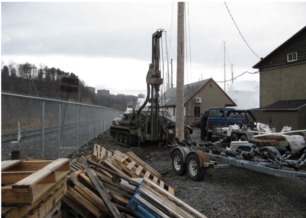
Photo 4 Réalisation du forage PO29 (8 avril 2010) secteur de la marina (vue vers le nord-est).
