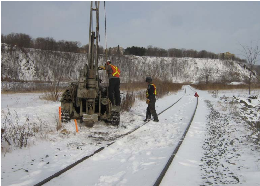
Photo 3 Réalisation du forage F6 (11 décembre 2009) en aval de l'ancien dépôt de Shell (vue vers le nord).
