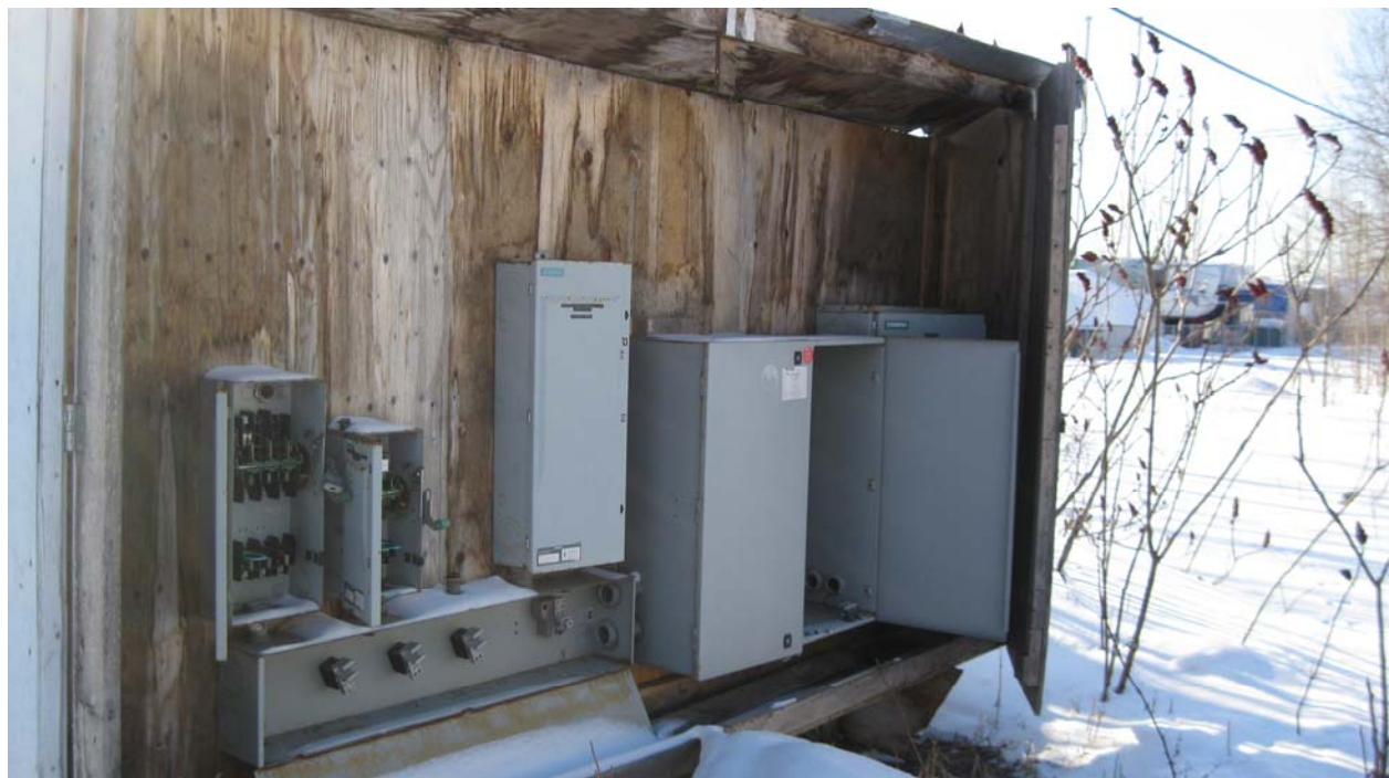
Photo 7a Vestige des installations électriques utilisées lors de la réhabilitation environnementale (Ancien dépôt de Esso - section 4).
