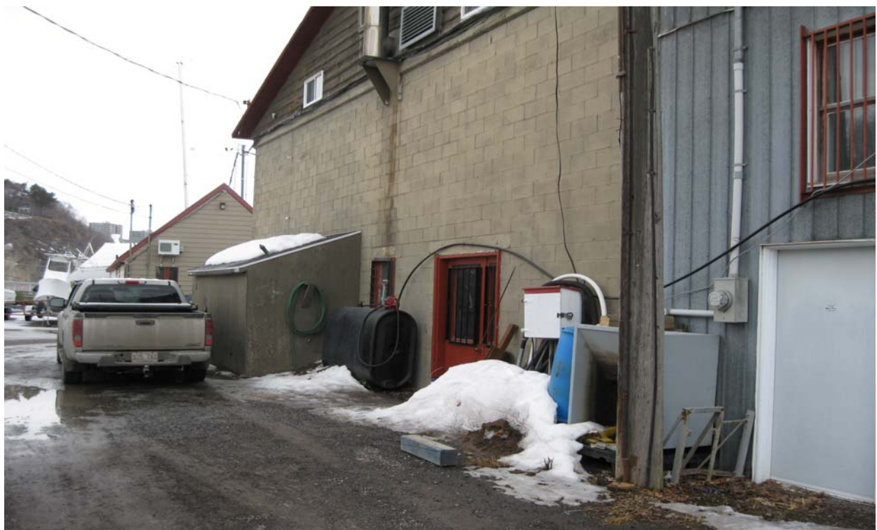
Photo 3 Réservoir extérieur de diesel.
