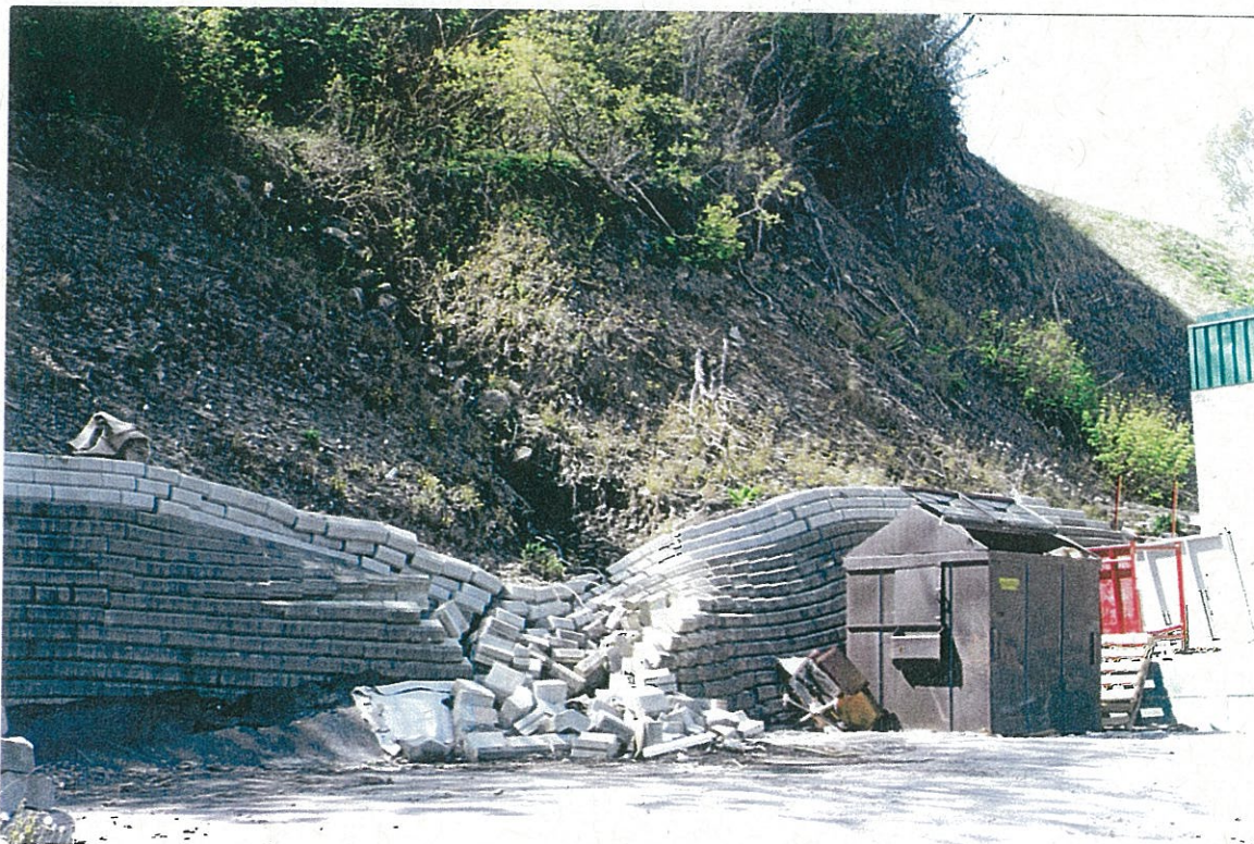
Photo 25 – Sommet et base de falaise à protéger
