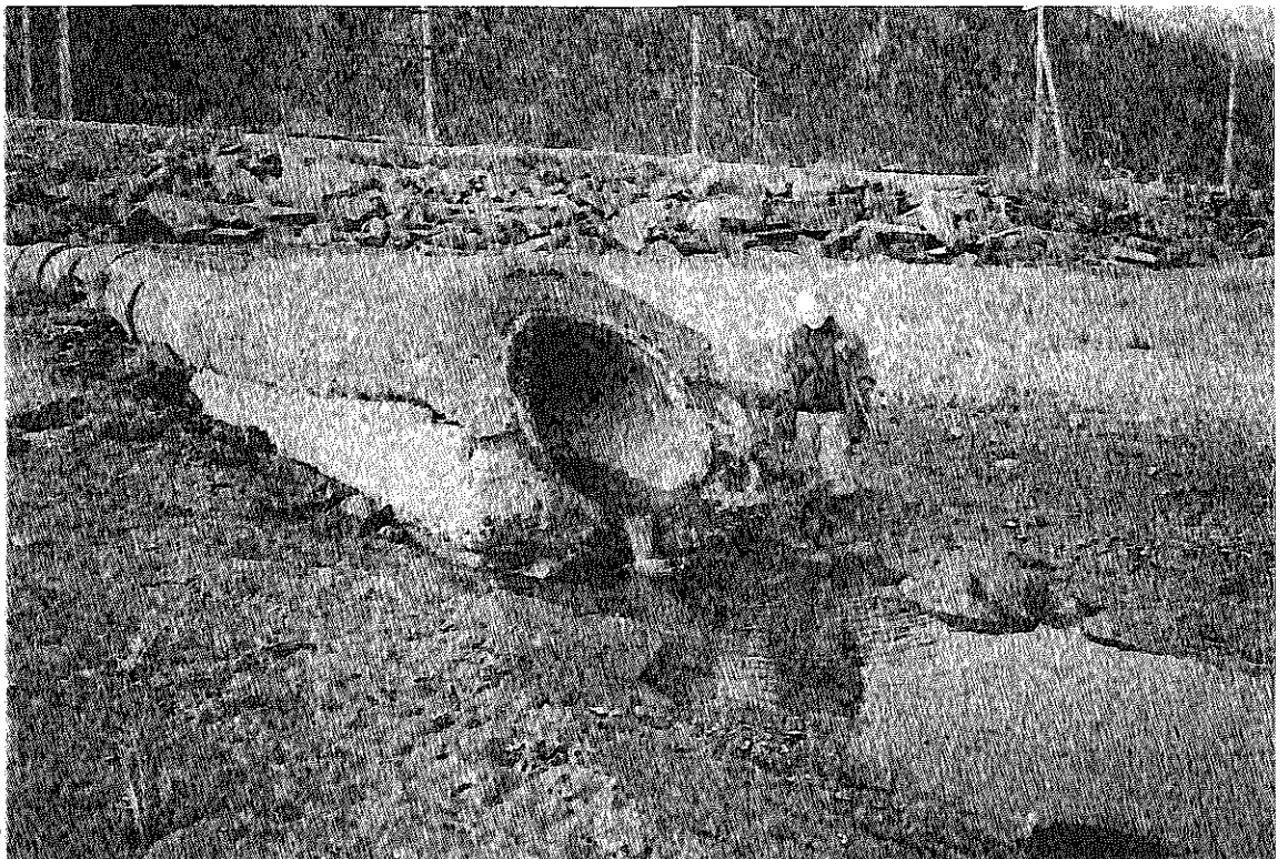
L'émissaire déstabilisateur de 48" de diamètre
