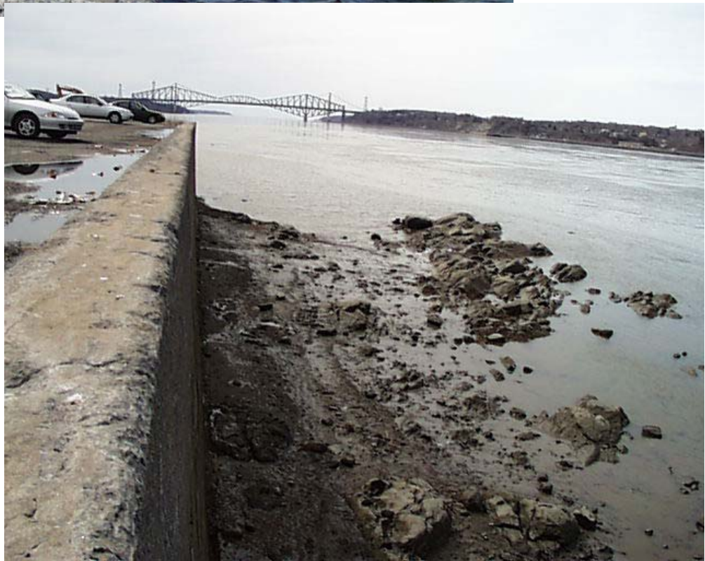
Photo #8 Usine de filtration, marée basse
