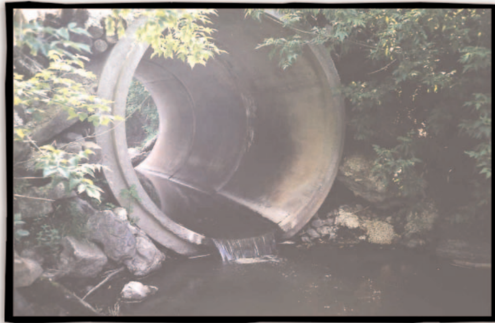
Photo 12. Exemple d'un ponceau installé de la mauvaise façon. Des ponceaux mal conçus, non suffisamment enfouis ou avec une pente inadéquate constituent des obstacles majeurs à la libre circulation du poisson, que ce soit pour son alimentation ou pour les activités de reproduction.
