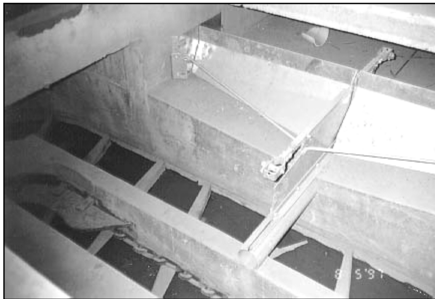
Figure 3. Séparation des fèces et des urines au dalot (caniveau)
