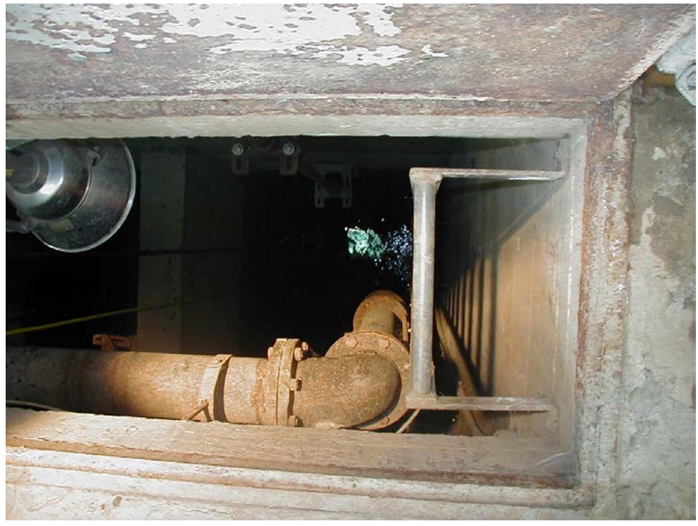
Photo n° 2. Puits où s'accumule l'eau provenant de la prise d'eau.
