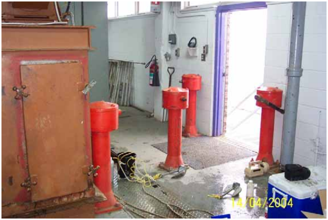
Photo n° 25. Intérieur de la station de pompage.
