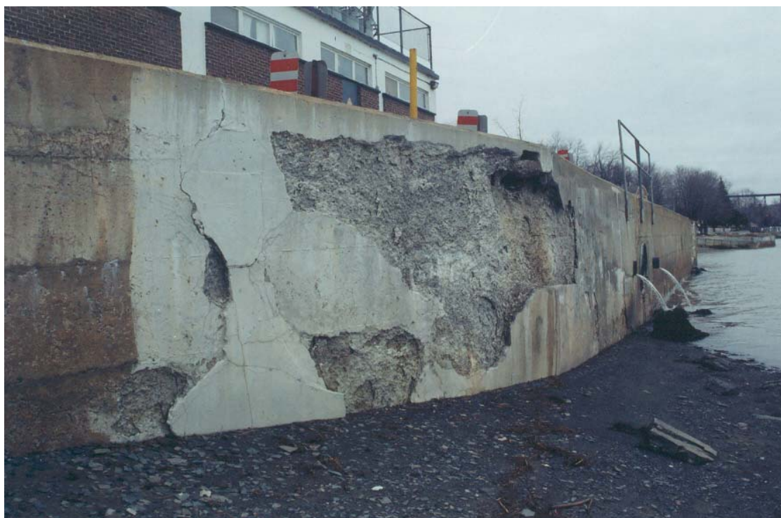
Photo 1 État du mur de soutènement derrière la station de pompage
