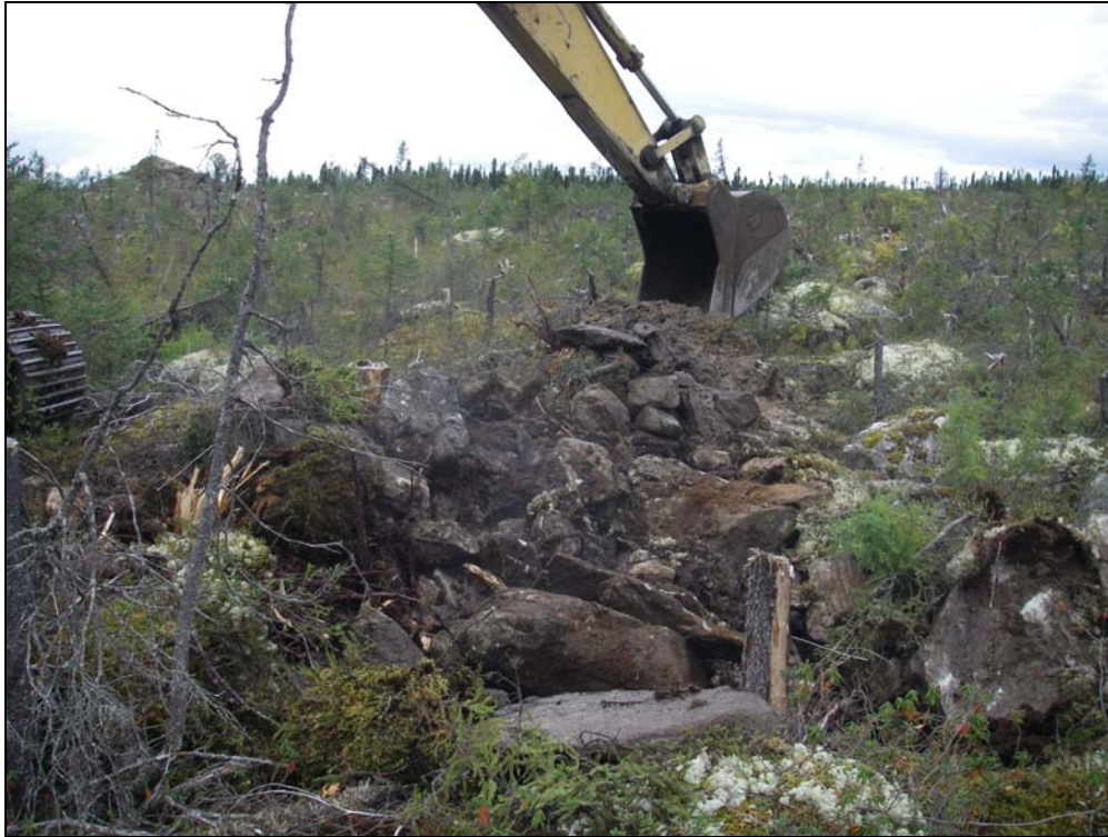
Photo 5 Travaux d'excavation effectués à l'aide d'une pelle hydraulique de la tranchée TR-151.
