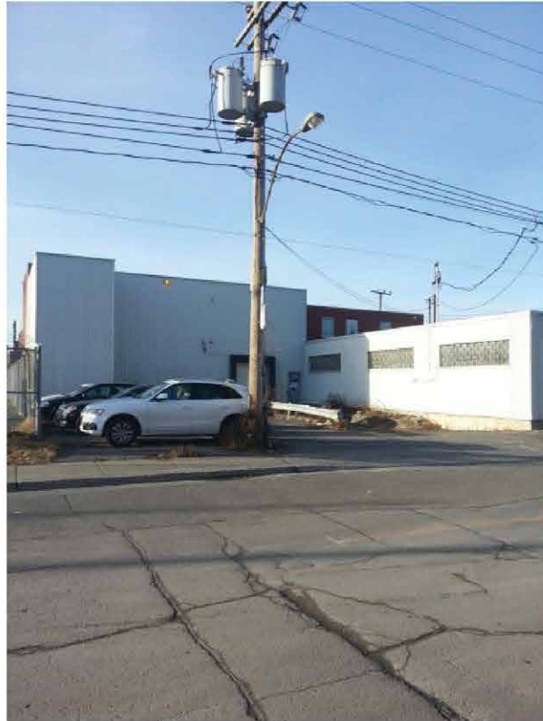
Photo 37 : Présence de transformateur électrique de distribution, lot 1 490 478, vue vers le nord
