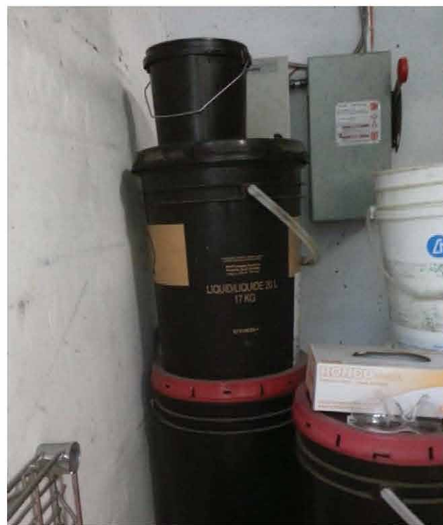
Photo 18 : Manipulation d'huile pour l'entretien des équipements électriques
