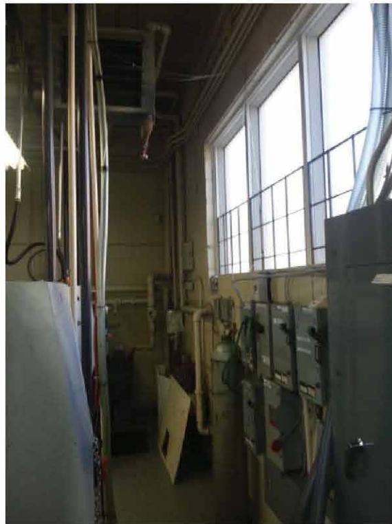
Photo 10 : Panneau de distribution électrique
