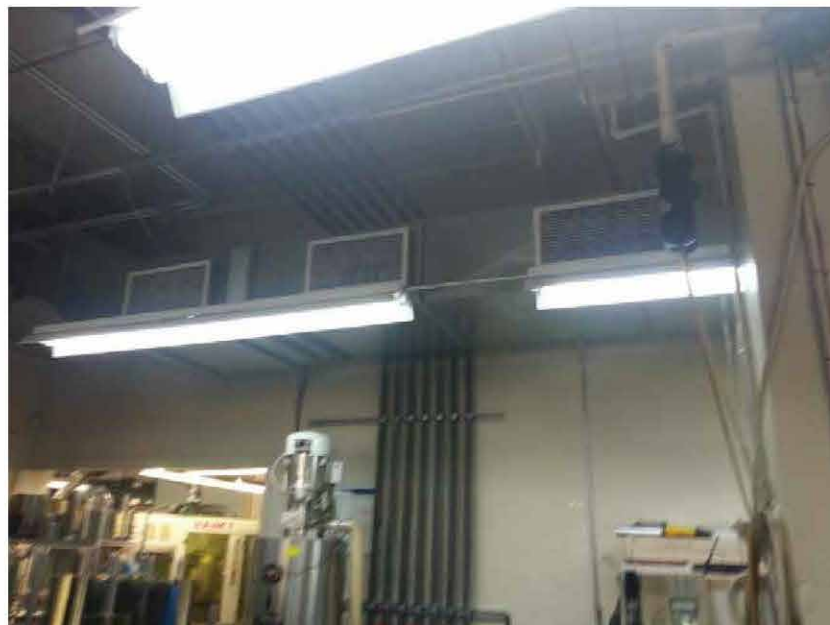
Photo 12 : Unités de climatisation et d'aération
