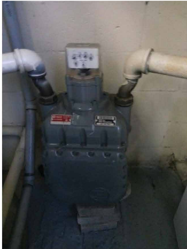
Photo 13 : Entré du gaz naturel
