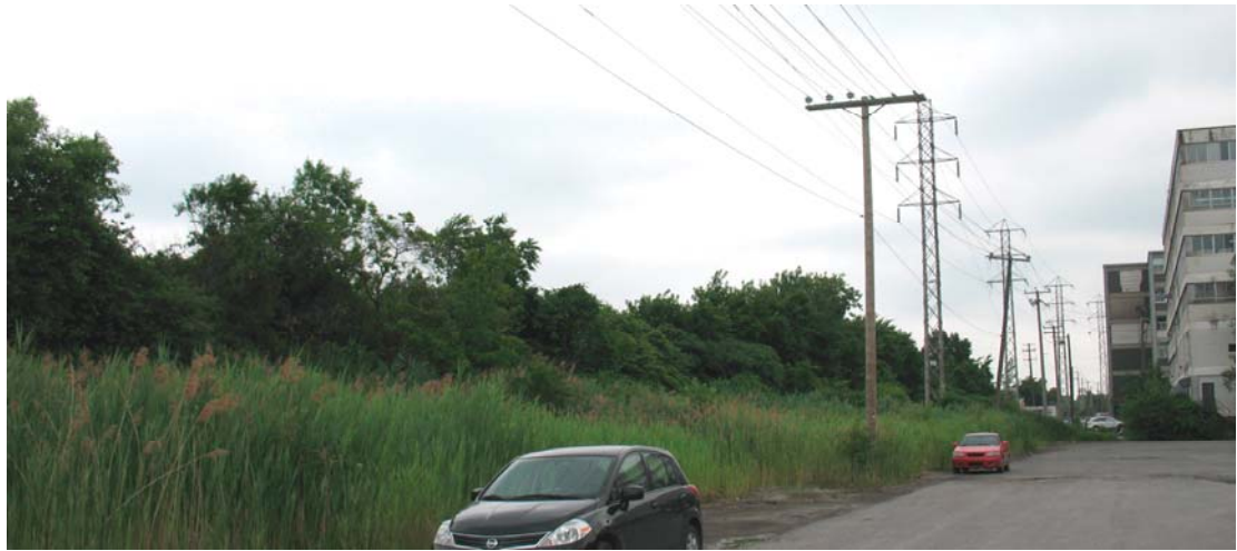
Photo 4-4 : Emprise de la ligne à 120 kV dans le secteur commercial Chabanel
