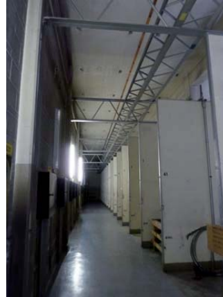
A. Lemarcis mercredi 24 novembre 2010 Ancienne salle de manœuvre 4 kV. Poste De Lorimier.
