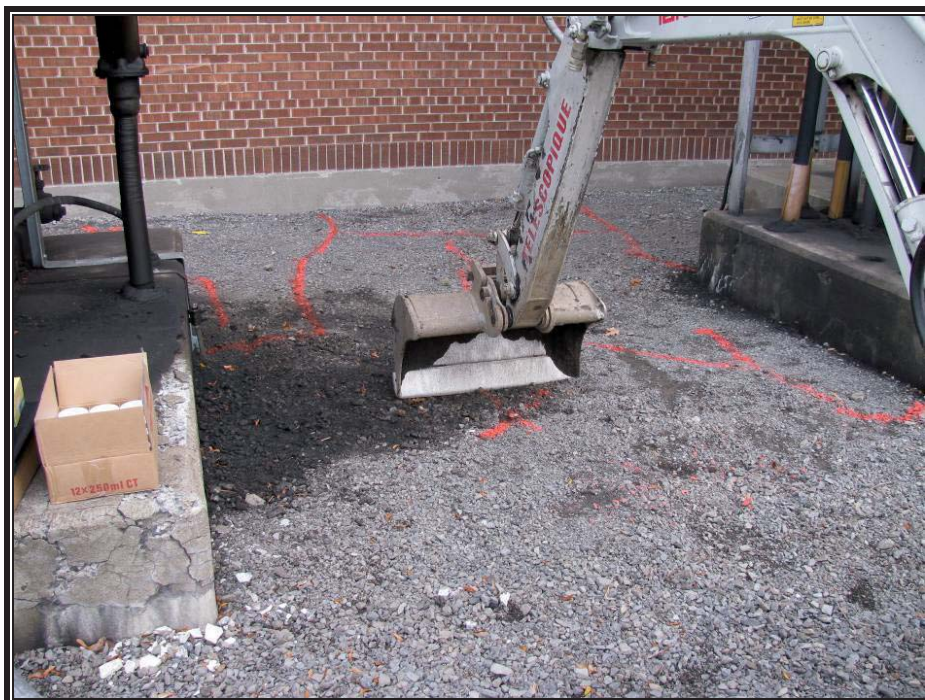
Photo 6 : Excavation de la tranchée TE-08-07 le long de la tâche d'huile (prise de vue est, 11 novembre 2008).
