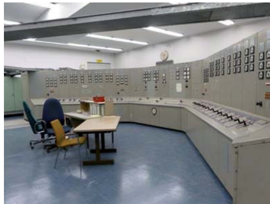
A. Lemarcis mercredi 24 novembre 2010 Salle de commande. Poste De Lorimier.
