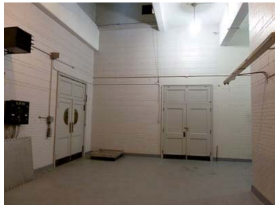
A. Lemarcis mercredi 24 novembre 2010 Rez-de-chaussée. Espace menant aux anciennes salles de manœuvre 4 kV. Poste De Lorimier.
