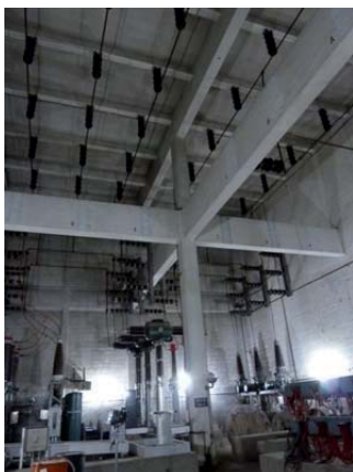
A. Lemarcis mercredi 24 novembre 2010 Salle de manœuvre 120 kV. Poste De Lorimier.
