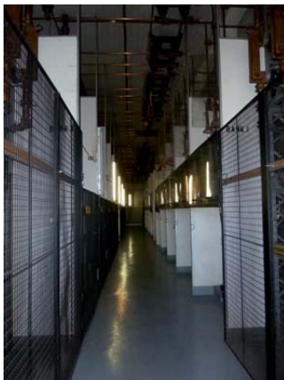
A. Lemarcis mercredi 24 novembre 2010 Salle de manœuvre 12 kV. Poste De Lorimier.
