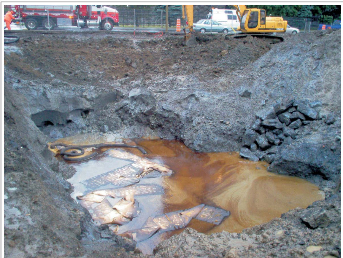
Photographie 6 : Phase libre en surface de l'eau de la fosse (EXC-2) avec présence d'absorbants.
