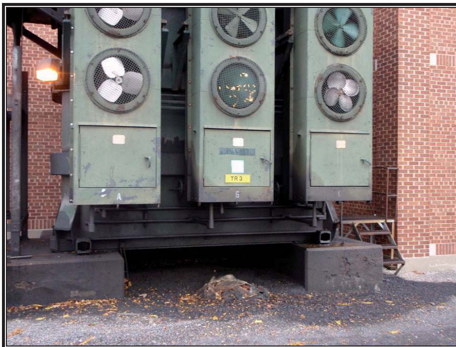
Photo 1 : Tâche d'huile au pied du transformateur T-3 (prise de vue est, 10 novembre 2008).
