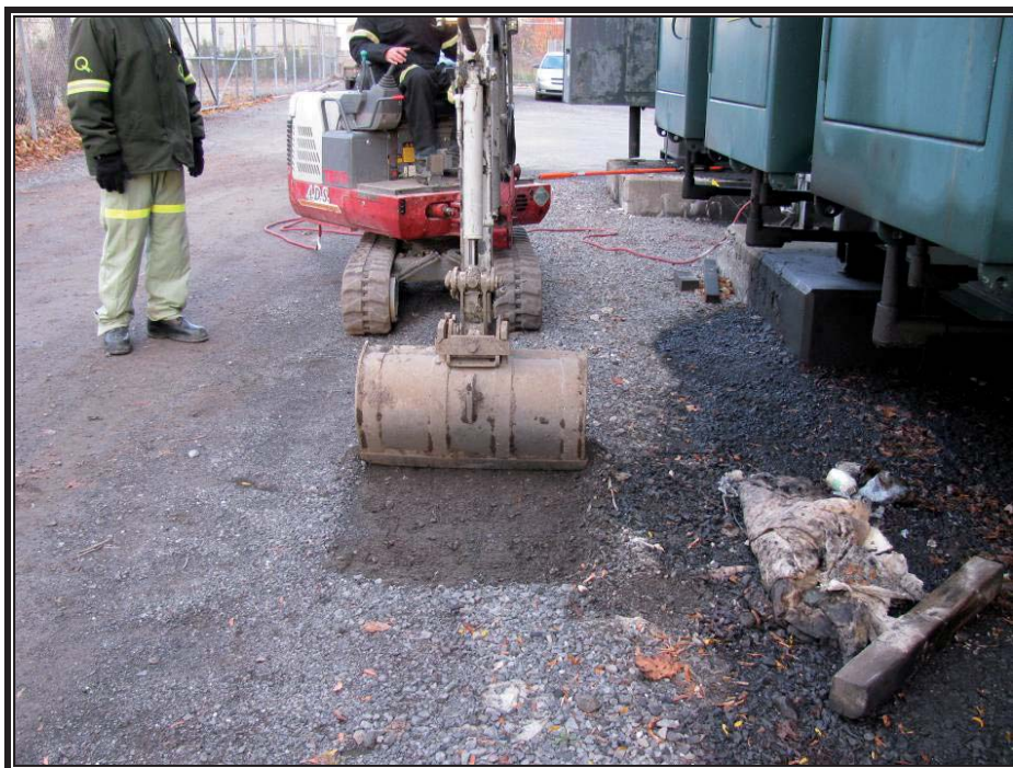
Photo 5 : Excavation de la tranchée TE-08-06 le long de la tâche d'huile (prise de vue nord, 11 novembre 2008).
