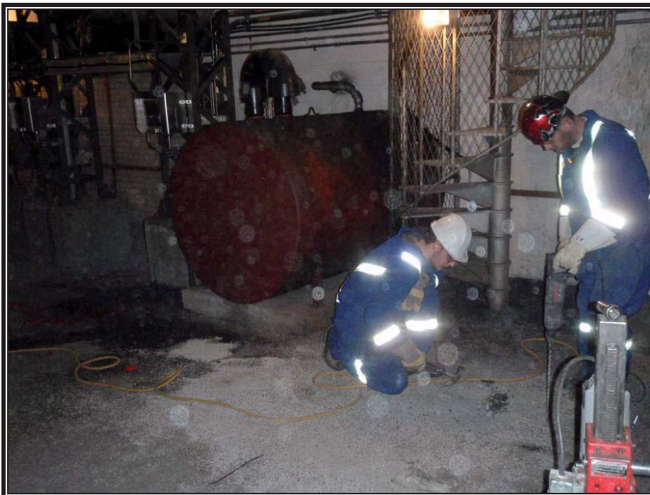
Photo 12 : Vue du forage F-08-03 au sous-sol proche du réservoir hors-sol d'huile (prise de vue ouest, 15 novembre 2008).
