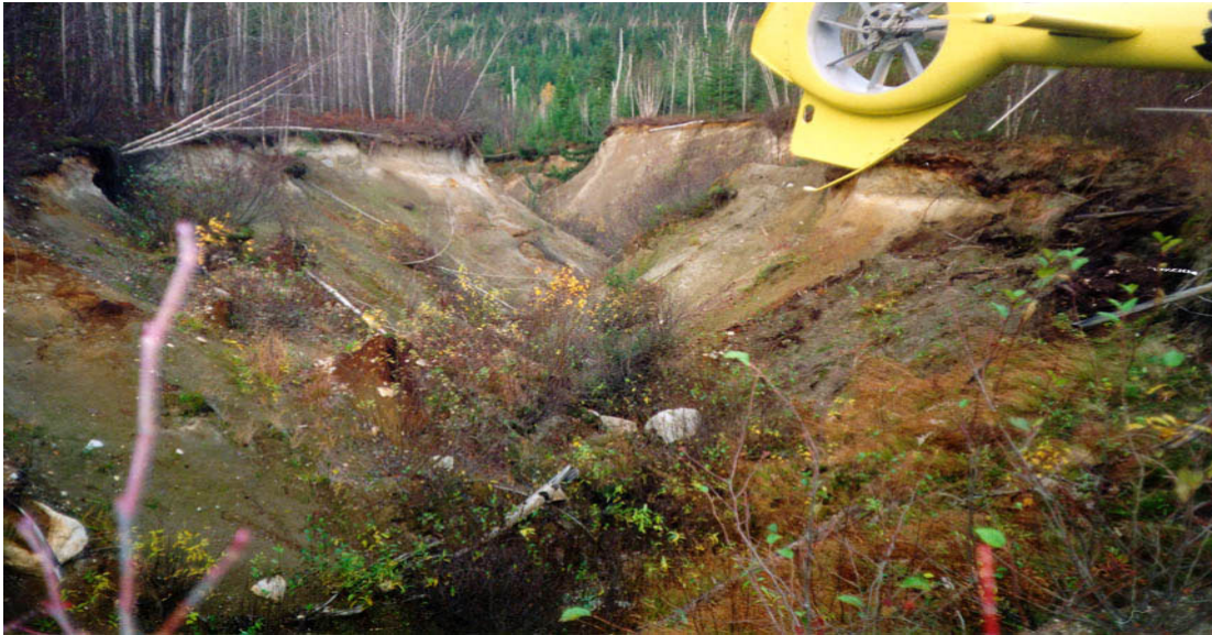
Figure 6-5 : Ravin au PK 154,5 de la Péribonka, en rive droite
