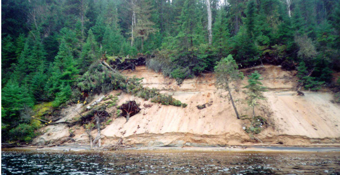
Figure 6-4 : Talus en érosion au PK 136,8 de la Péribonka, en rive gauche
