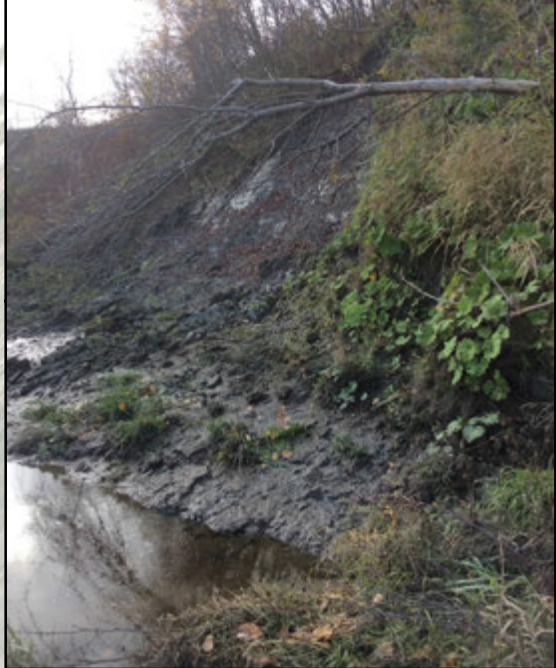
PHOTO 2: VUE MONTRANT L'INSTABILITÉ DE LA RIVE DROITE
