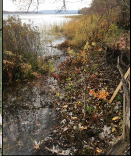
PHOTO 2: VUE D'UNE DÉCHARGE RAVINÉE EN RIVE DROITE
