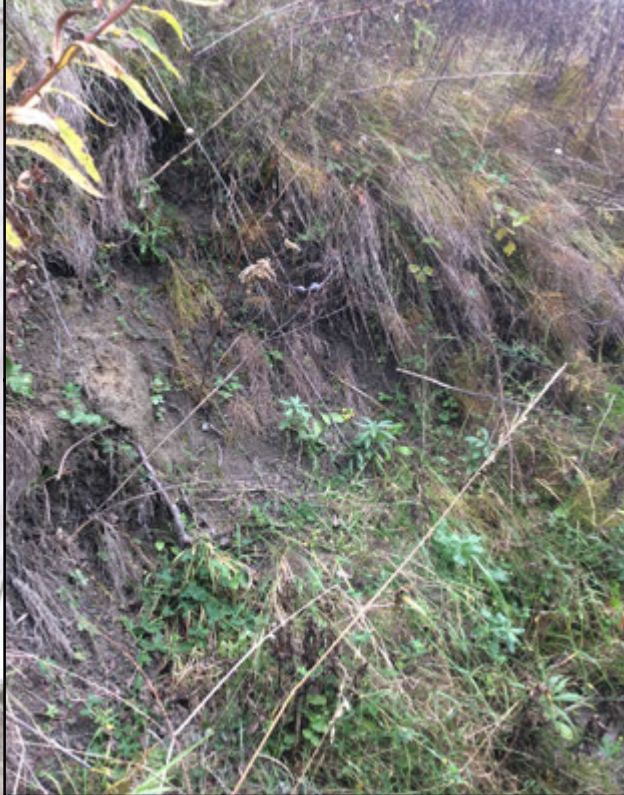
PHOTO 2: DÉCROCHEMENT EN RIVE GAUCHE
