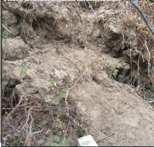
PHOTO 4: DÉCROCHEMENT EN RIVE DROITE
