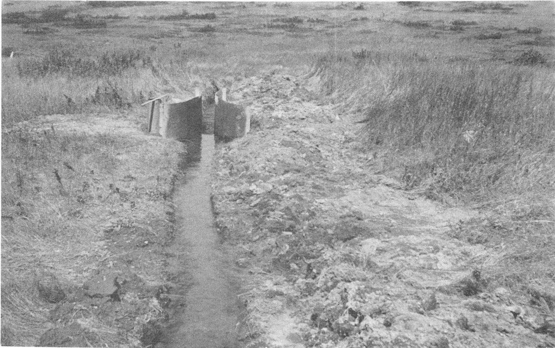
A—Mesure du débit à l'aide d'un canal "Parshall"
