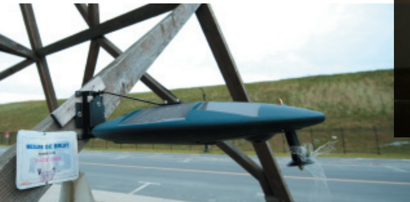
Station de mesure du bruit
