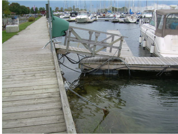
Photo 6 : Raccordement du quai flottant 10 au quai fixe en rive. Le quai flottant 9 est visible en arrière-plan.
