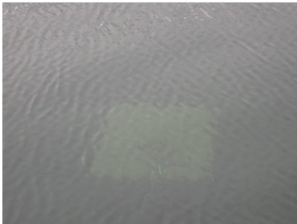
Photo 11 : Bloc de béton submergé pour l'ancrage des quais. Chaque bloc occupe une superficie d'environ 0,74 m 2 .
