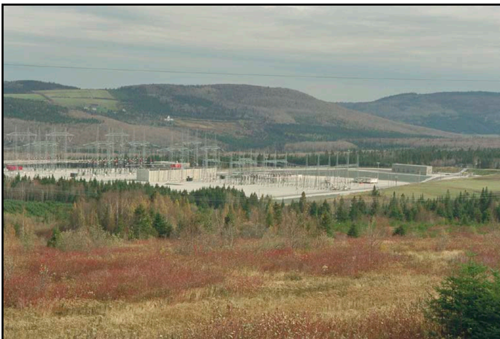
Photo F-4 : Poste des Appalaches à 735-230 kV
