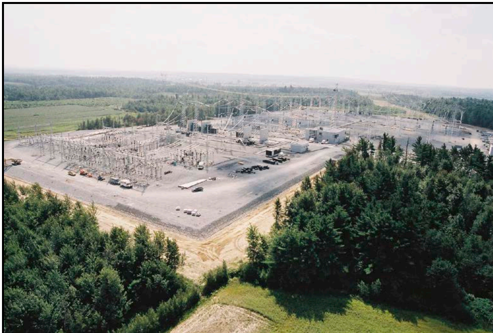
Photo F-2 : Poste de la Montérégie à 735-120 kV
