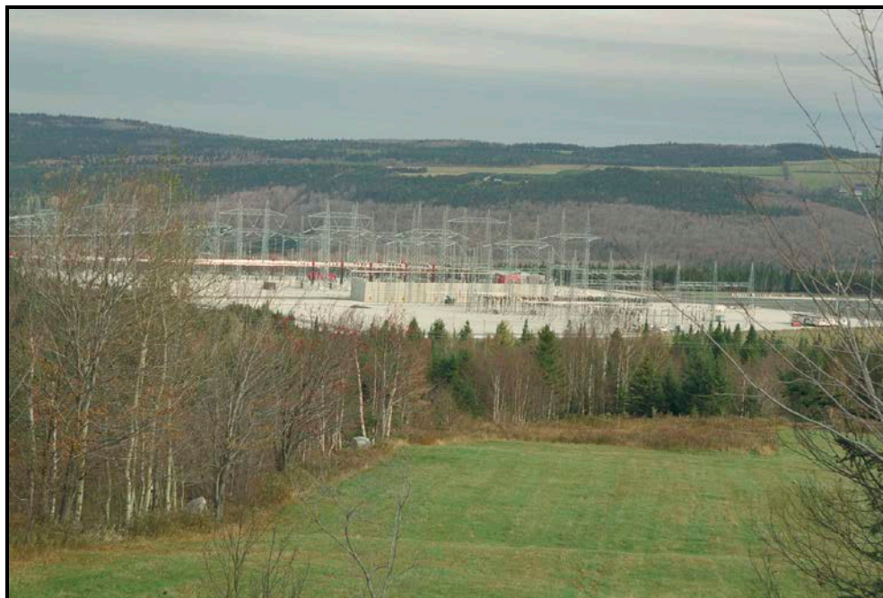
Photo F-5 : Poste des Appalaches à 735-230 kV
