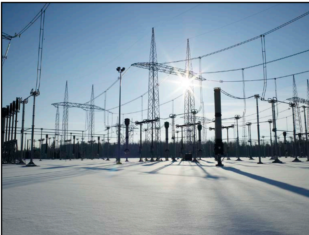
Photo F-3 : Jeux de barres à 735 kV à l'intérieur du poste de la Montérégie
