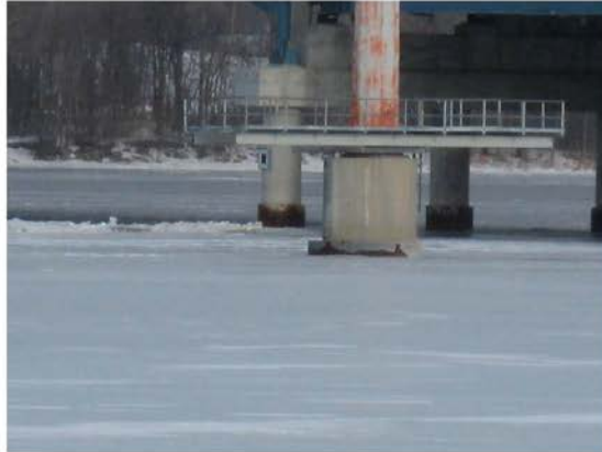
Figure 11 : état de la surface de la glace de berge autour du pylône de la ligne Duvernay-Anjou situé au centre de la rivière des Prairies (1 01 février 2013)
