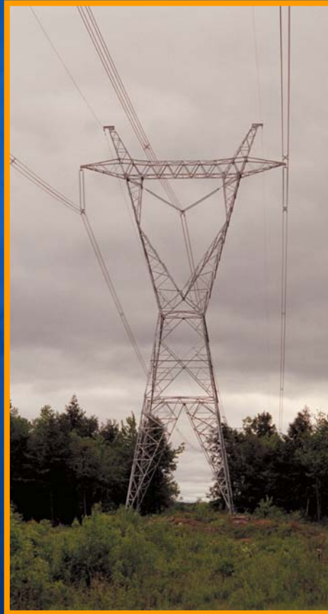
Exemple de pylônes à 4 pattes
