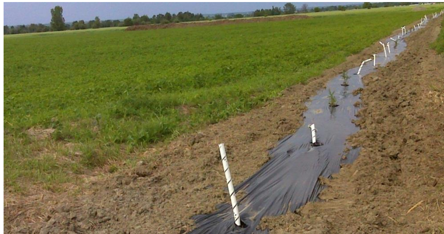
Image 2 : Mise en place d'une haie brise-vent pour le contrôle de l'érosion éolienne chez un producteur de Saint-Maurice
