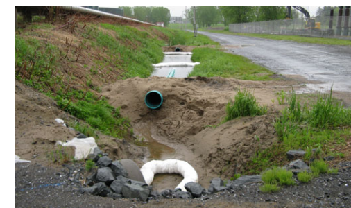
Photo I.4 : Boudins absorbants installés au niveau d'un ponceau inversé
