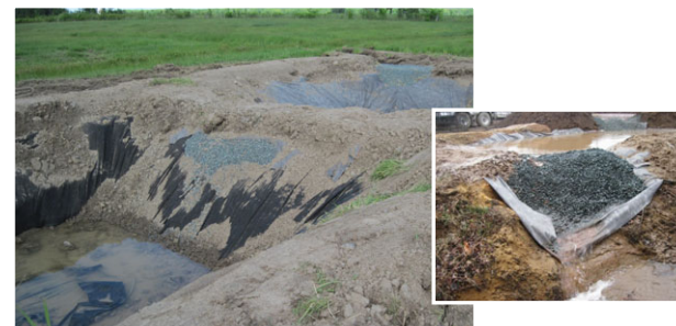
Photo G.2 : Trappe à sédiments double, projet de la ligne Nicolet-Bécancour
