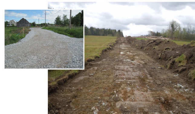
Photo D.1 : Décapage en vue de la construction d'un chemin et mise de côté de la terre arable, projet de la ligne du parc éolien De L'Érables
