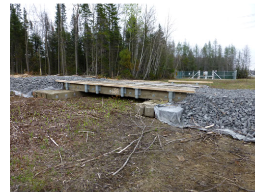
Photo H.4 : Traversée d'un gazoduc, projet du poste au nord de Blainville
