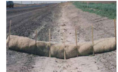
Photo F.13 : Boudin de rétention
