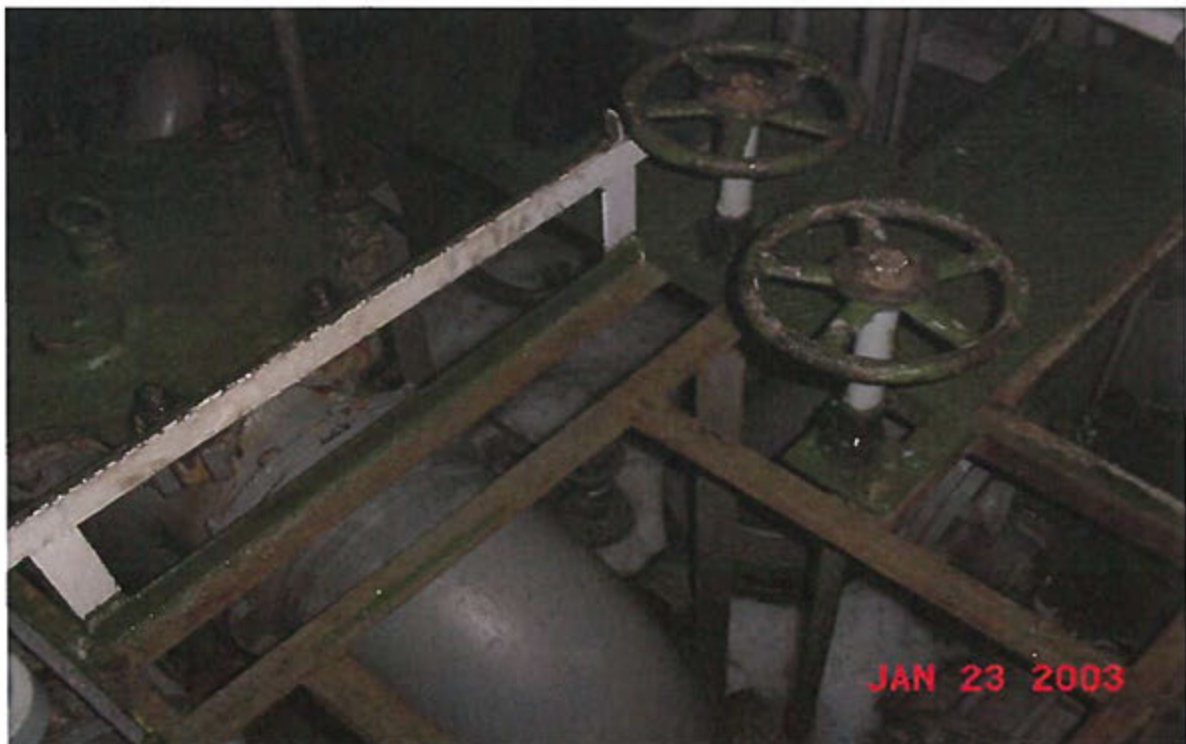
Figures 3.7B – Accumulation de glace dans les fonds attribable au nettoyage des crépines
