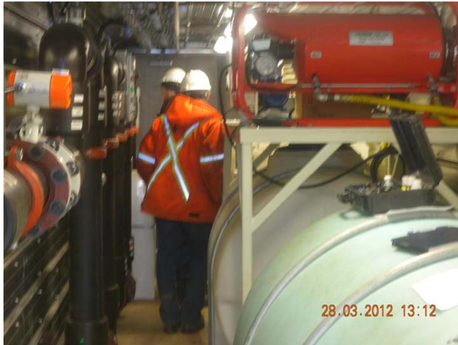
Photo 16-2 : Intérieur de l'usine de floculation utilisée sur le chantier de Sheldrake (Source : AXOR)
